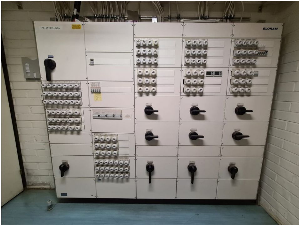
Kuva 32. Kiinteistön pääkeskuksen lisäosa
