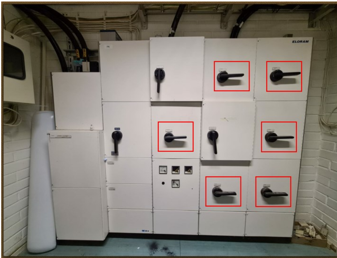
Kuva 22. Kuva esimerkkikohteen sähköpääkeskuksesta, johon on merkitty vapaana olevat lähdöt
