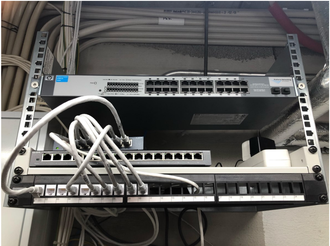
Kuva 9. Yleiskaapelointijärjestelmän jakamo asennettuna teknisen tilan seinälle.
