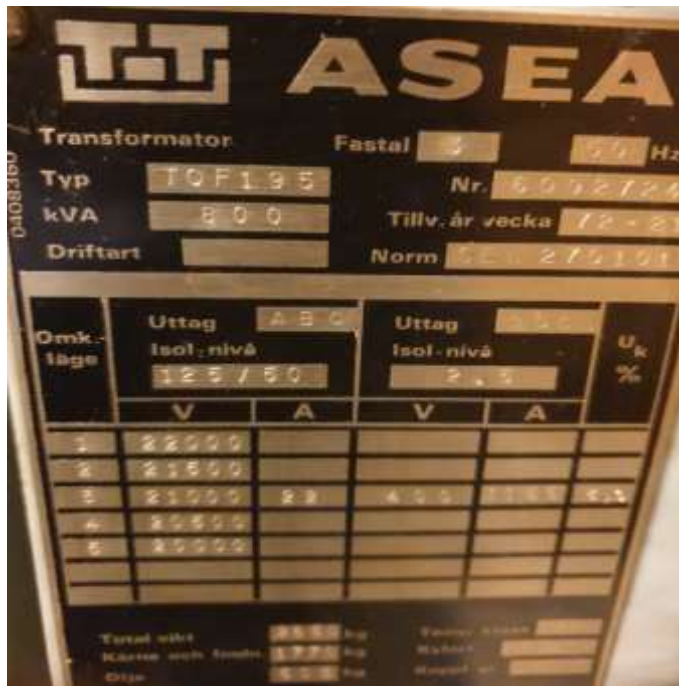
KUVA 20. Muuntajan arvokilpi (Kuva: Suntinen. 2020)
