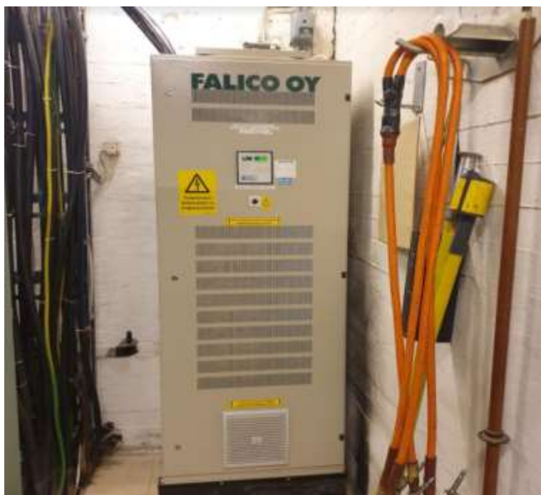
KUVA 38. Alamuuntamon kompensointilaitteisto (Suntinen. 2020)
