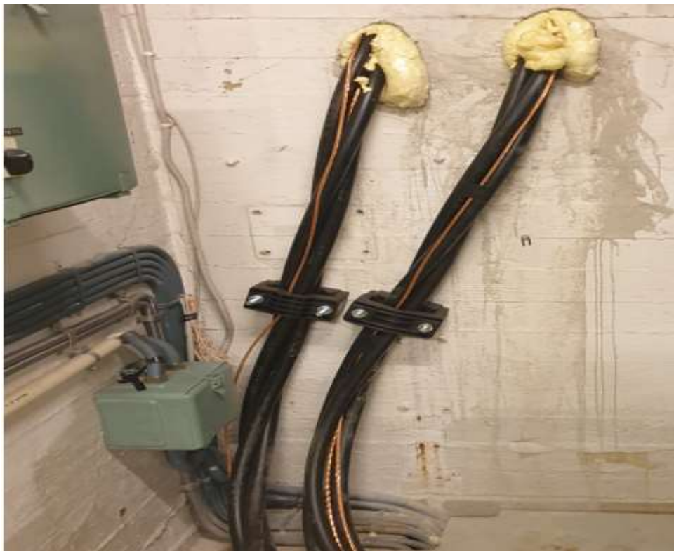
KUVA 28. Muuntamon syöttökaapeli (Kuva: Suntinen. 2020)
