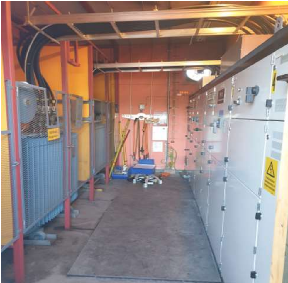
KUVA 29. Ylämuuntamo (Kuva: Suntinen 2020)
