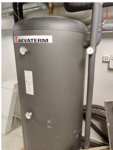
Kuva 9. 750 litran Akvaterm JV-750 E -kylmävesivaraaja Technobothnian kellarissa.
