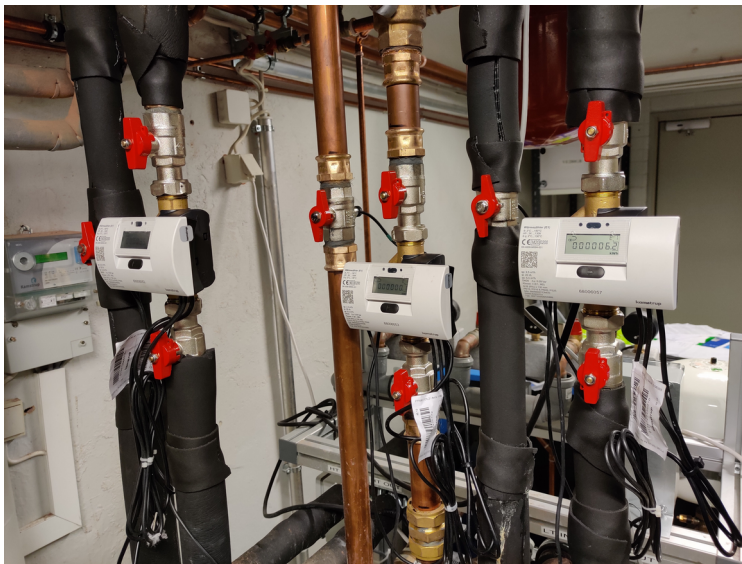
Kuva 18. Kampstrup Multical 302 -mittarit kytkettyinä vesipiiriin.
