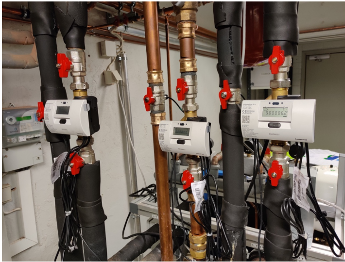
Kuva 1. Jäähdytinjärjestelmän vesipiirin putket sekä niihin liitetyt energiamittarit.
