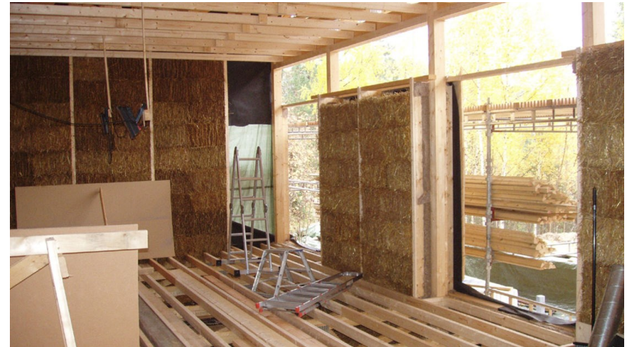
Kuva 22 Oljesta tehtyjä rakenteita. (Kuva: YLE)
