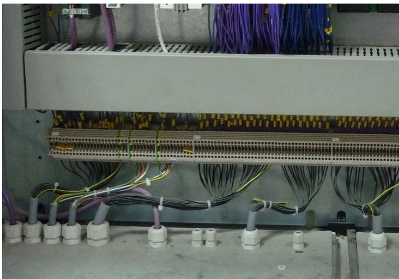
Kuva 17. Kaapeleiden läpiviennit toteutettuina läpivientiholkeilla.
