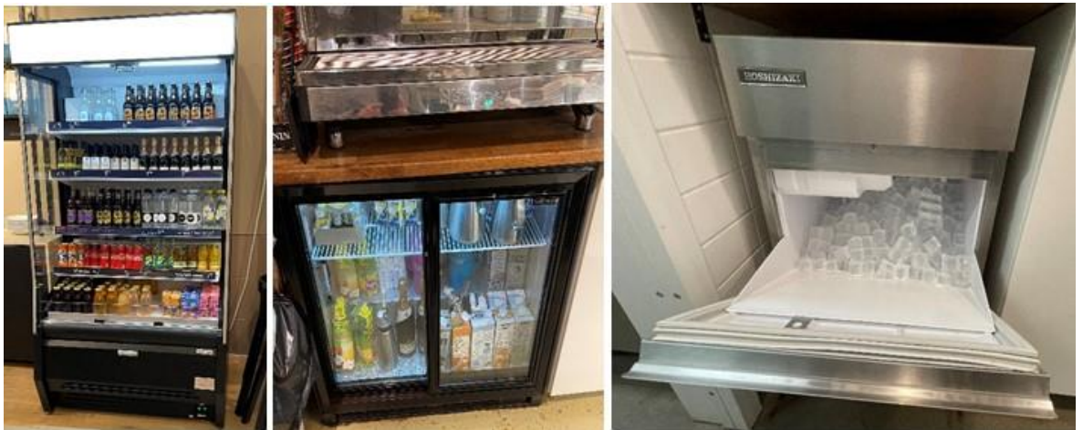
Kuva 6. Virvoitusjuomakylmäkaappi, kahvipohjaisten juomien valmistuksessa käytettävien viileässä säilytettävien ainesosien kylmäkaappi sekä jääpalakone.
