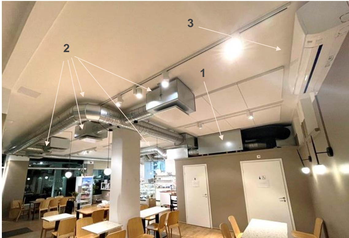
Kuva 9. Ilmanvaihdon kone (1), ilmanvaihtokanavistoa (2) ja ilmanviilennyskoneen sisäyksikkö (3).
