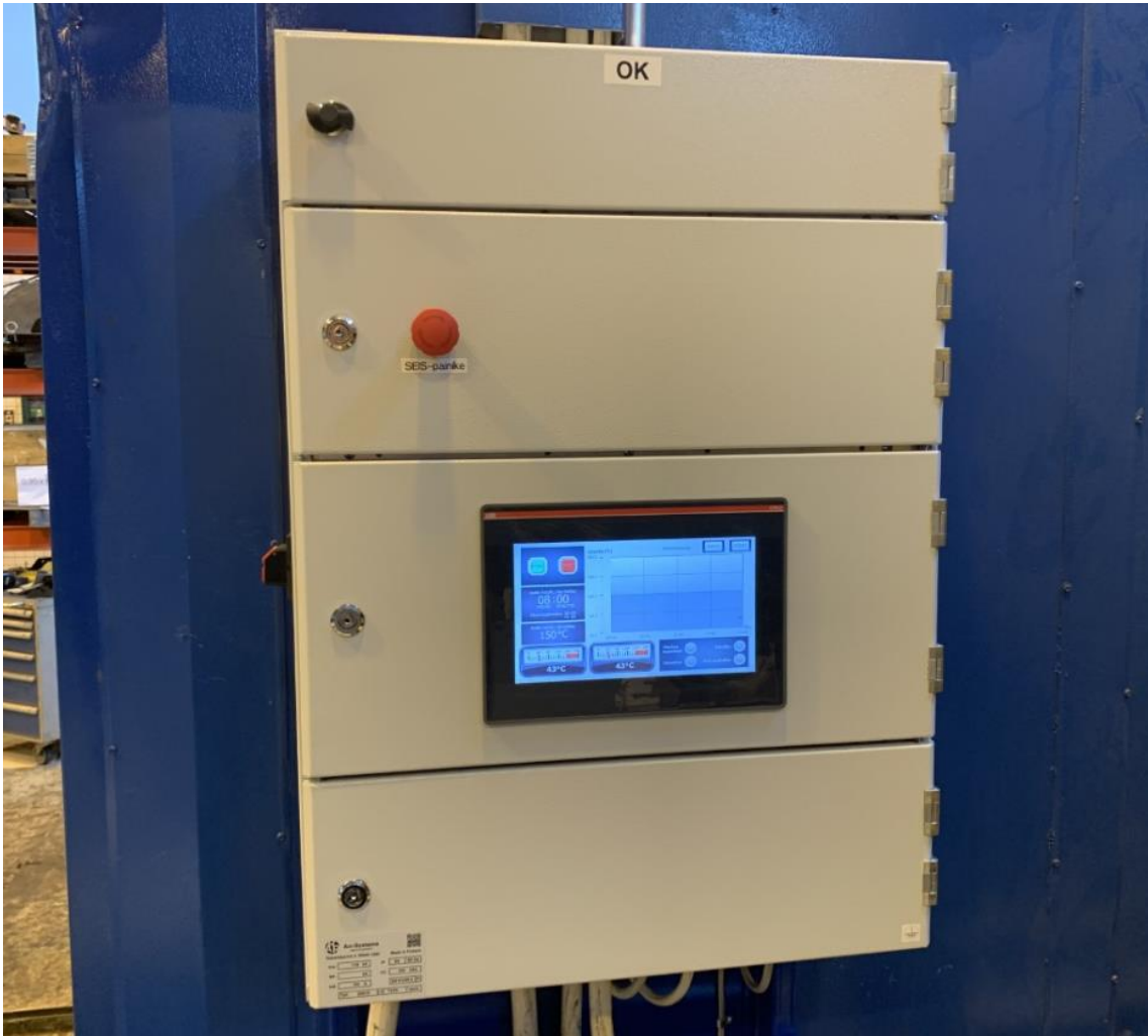
KUVA 28. Uusi ohjauskeskus asennettuna
