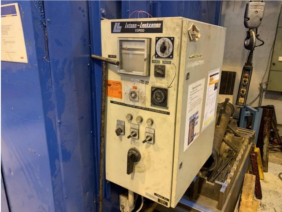
KUVA 1. Uunin vanha ohjauskeskus
