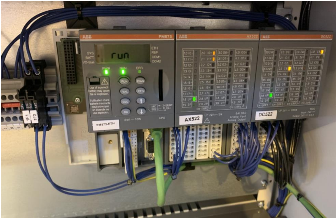
KUVA 22. PLC paikallaan keskuksessa
