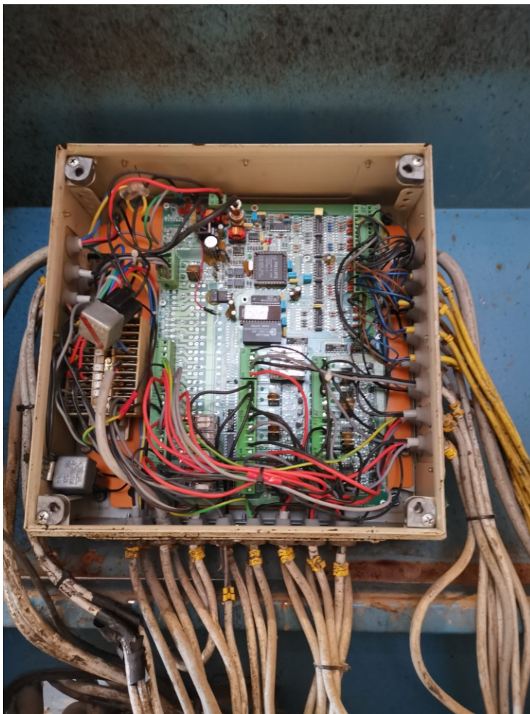
KUVA 2. Nostokoneen alkuperäinen ohjainlaite (Kuva: Eelis Korjus 2020)
