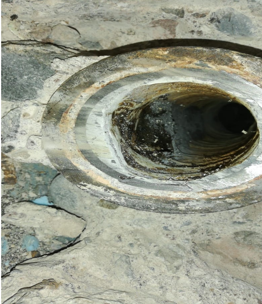
Kuva 6. Puhdistamaton valurautaviemäri. (kuva QL-kohteesta)
