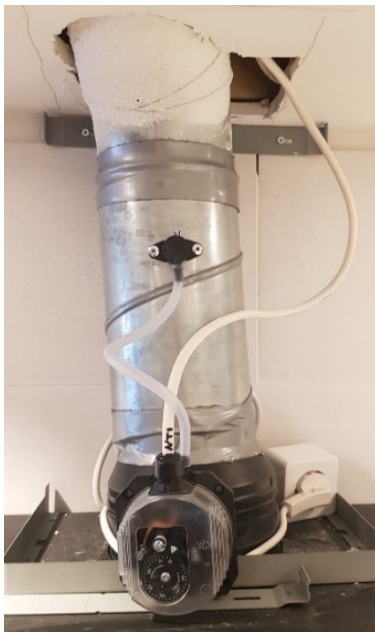
Kuva 10. Paine-erokytkin Produl CPS 330, jonka mittausliitin on asennettu kanavaan [kuva Sami Mäkinen].
