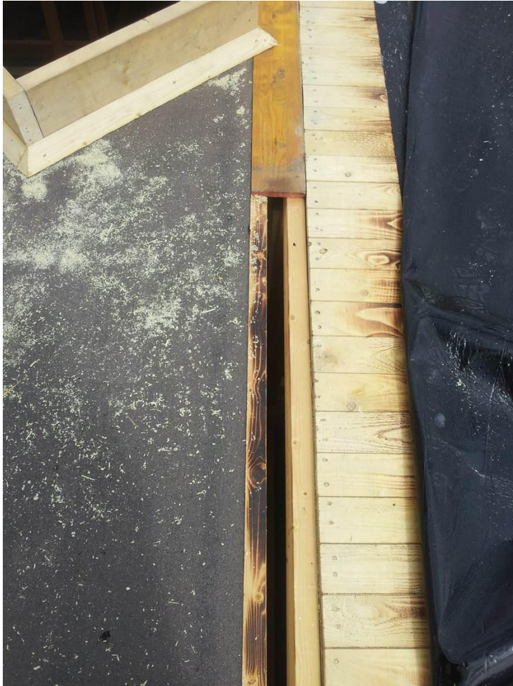
Kuva 15 Vaneritäyte vesikattoelementtien saumassa.
