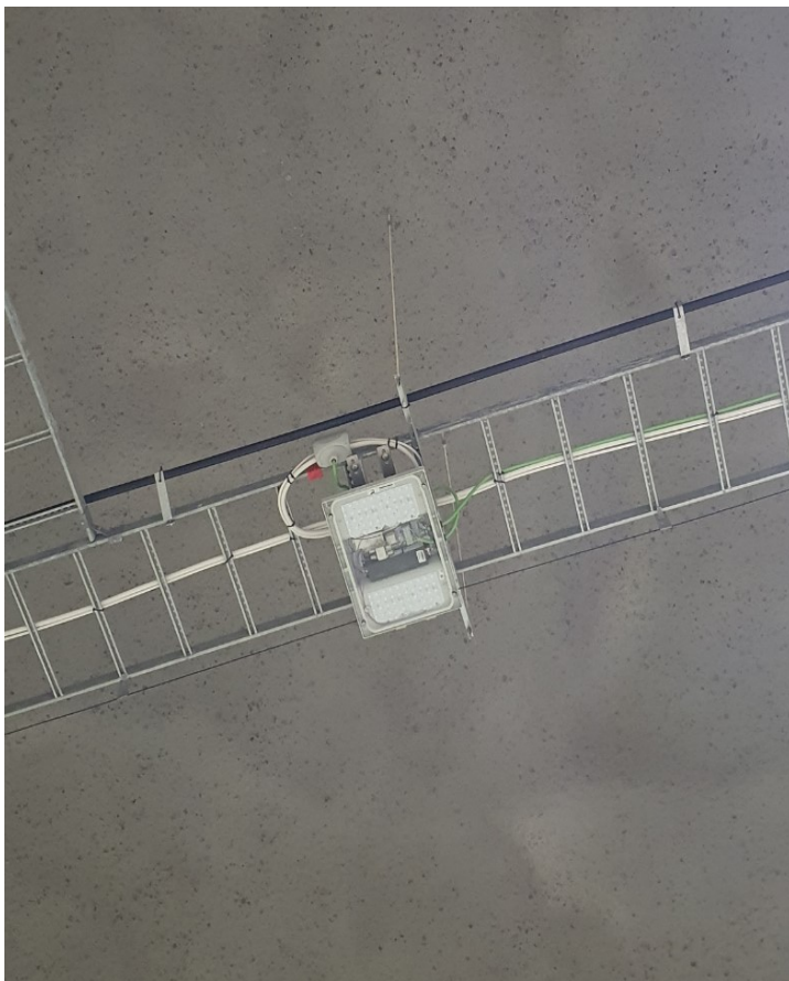
Kuva 13. Tunnelin LED-valaisin asennettuna tikashyllyyn.
