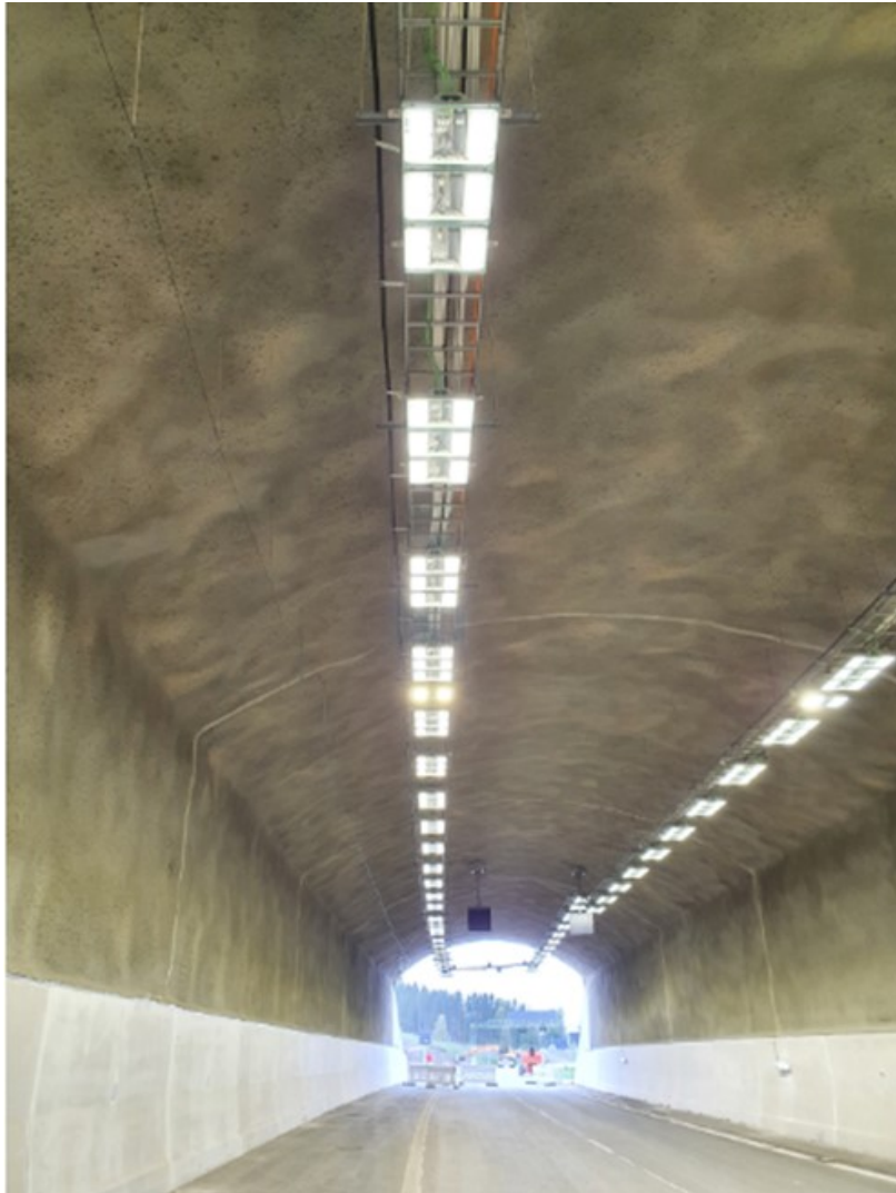
Kuva 16. Liipolan tunnelin läntinen suuaukko, kynnyksalueen valaistus.
