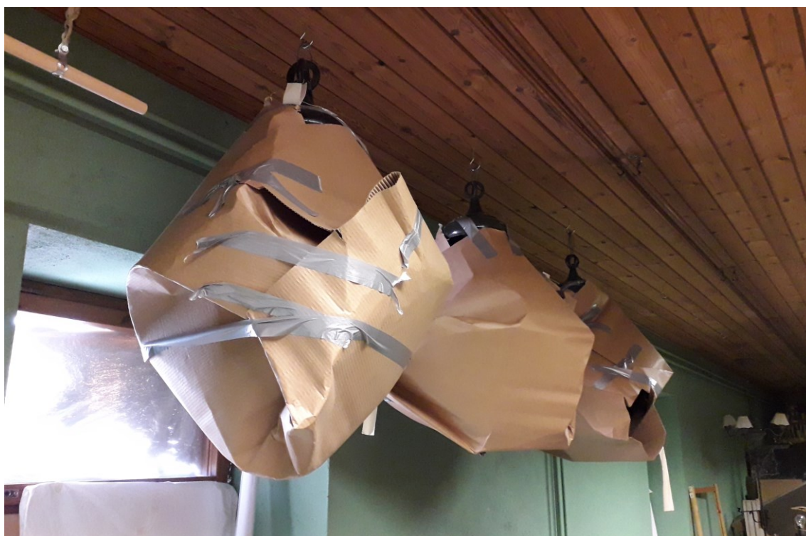
Kuva 5. Edellisen muuton yhteydessä käytettyjä epäsopivia pakkausmateriaaleja ei ole poistettu katossa roikkuvista paloilmaisinleijoista.
