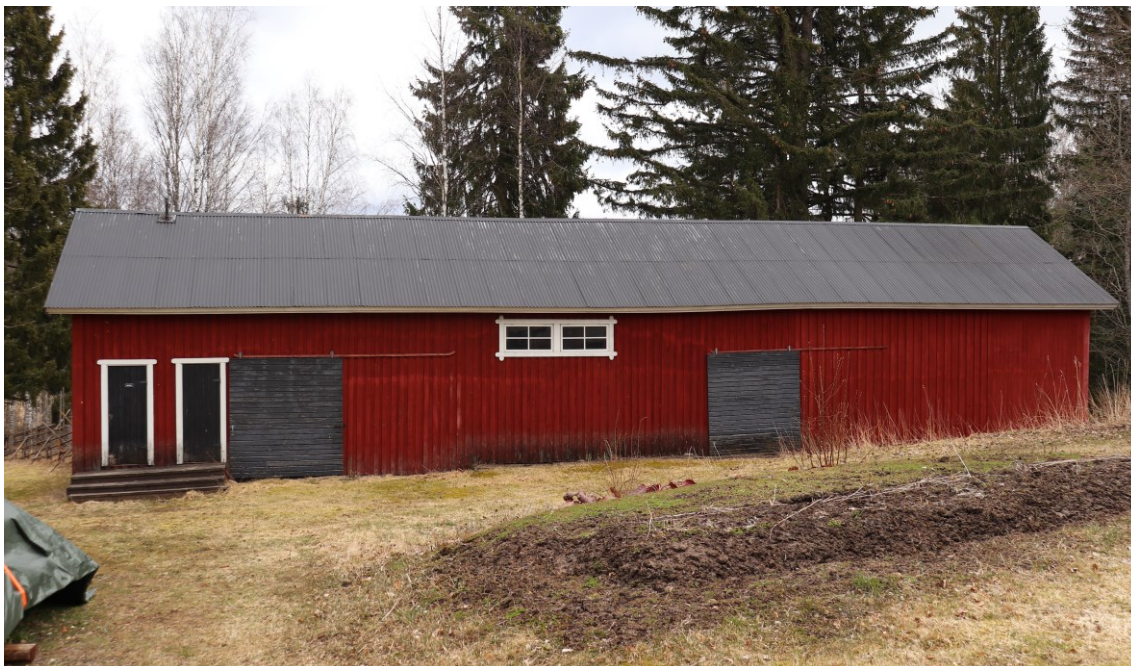
Kuva 4. Vehkalahden kotiseutumuseon ulkorakennus, jossa säilytetään kokoelmaesineitä. Rakennus on kärsinyt muun muassa kosteusvaurioista. (Haminan kaupungin museot)
