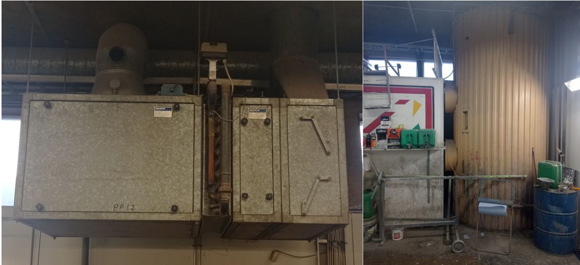
KUVA 4. Korjaamohallin korvausilmakoje ja sen lämmittämiseen käytetty lämminvesivaraaja
