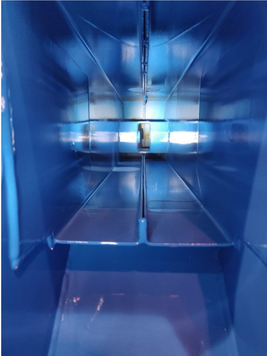
Kuva 5. Tectyliä levitetty paljaan teräspinnan päälle nivelvarren pätyyn, sekä kapeisiin välikköihin, joissa on pätkähitsejä.
