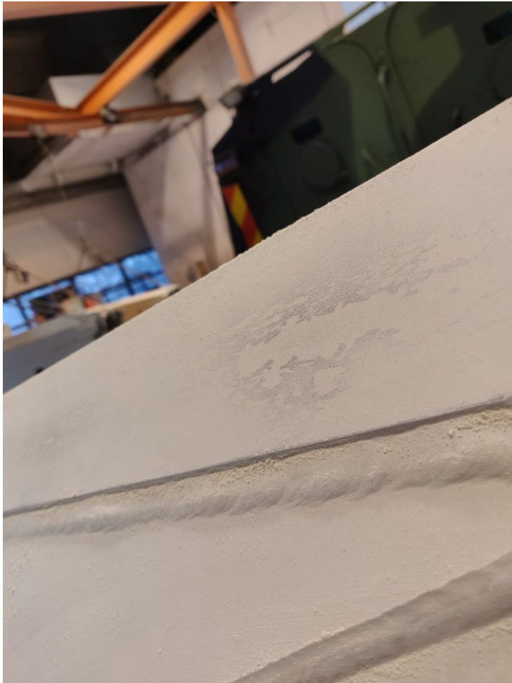
Kuva 2. Teräspinnan syöpymää hyvin nähtävillä pohjamaalauksen ja hionnan jälkeen.
