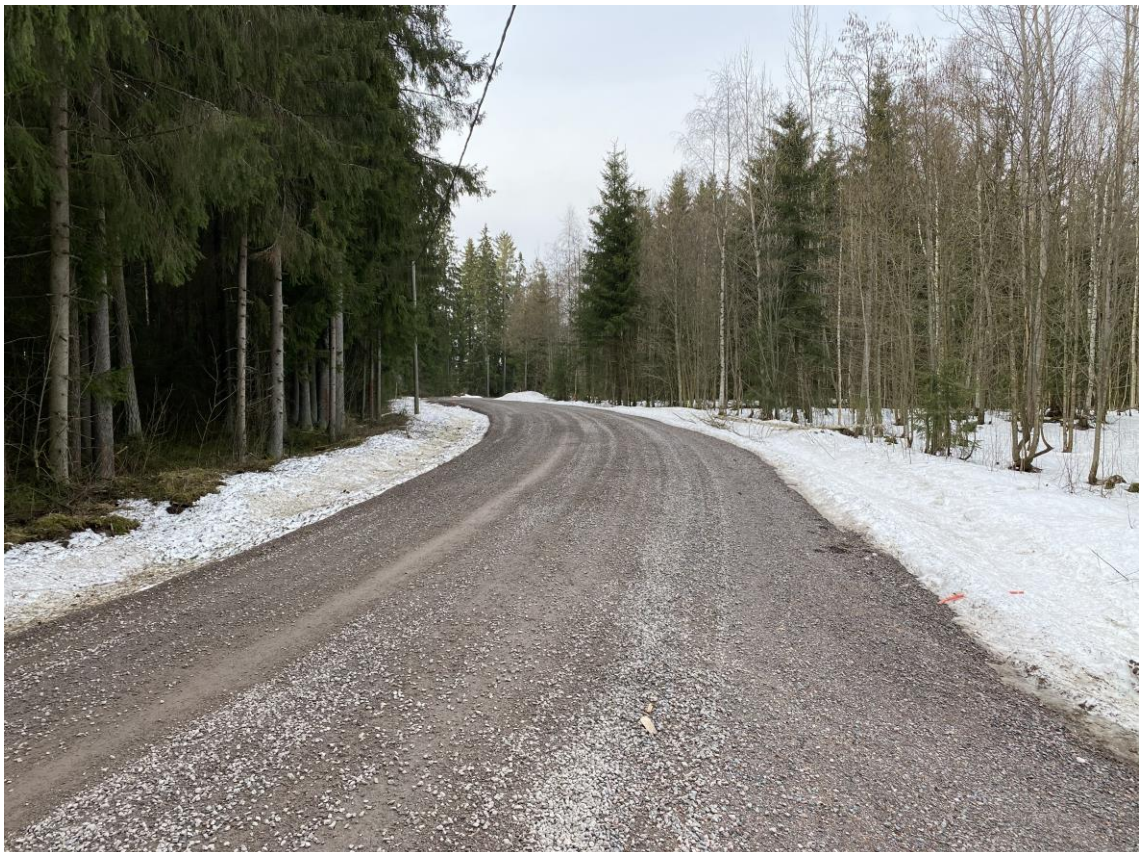
KUVA 24. Rakenne 1. T:5, K:2, P:5.
