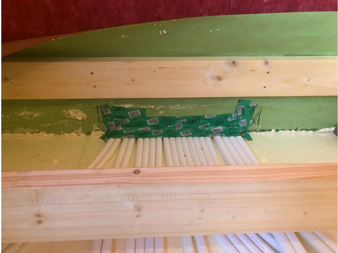
Kuva 12. Uudet vesikiertoiset lämmityspotket kulkevat lattian alla suojaputken sisällä pannuhuoneeseen. Kuvassa näkyy myös ilmansulkukaistale seinällä sekä 50 mm Finnfoam lämmöneristelevy.
