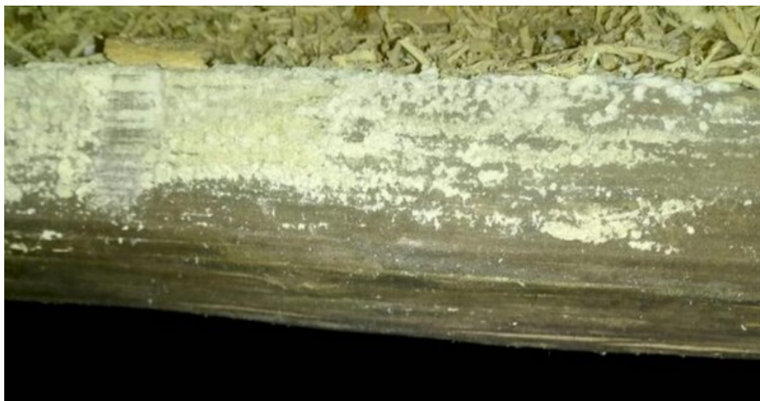
Kuva 5. Tuulettuvan alapohjan rakenteiden kosteusvaurioita.
