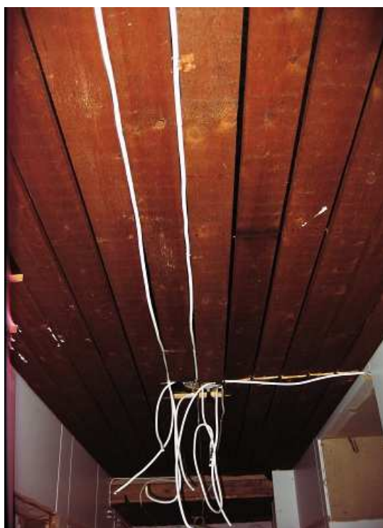
Kuva 10: Eteisen vanha lautakatto ja johdotuksia.
