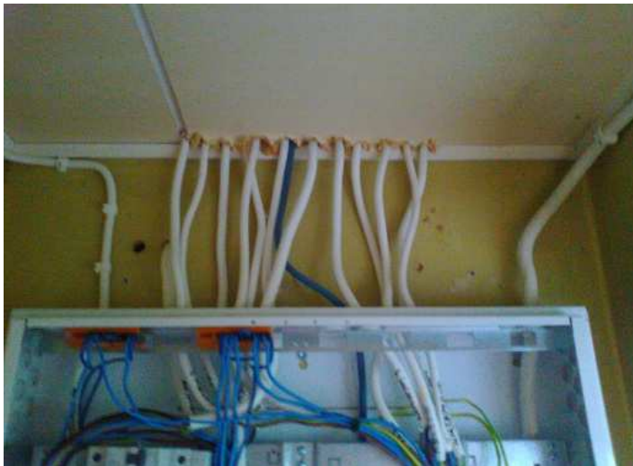
Kuva 17: Keskukseen lähtöjä, jotka menevät katon läpi välikatolle.
