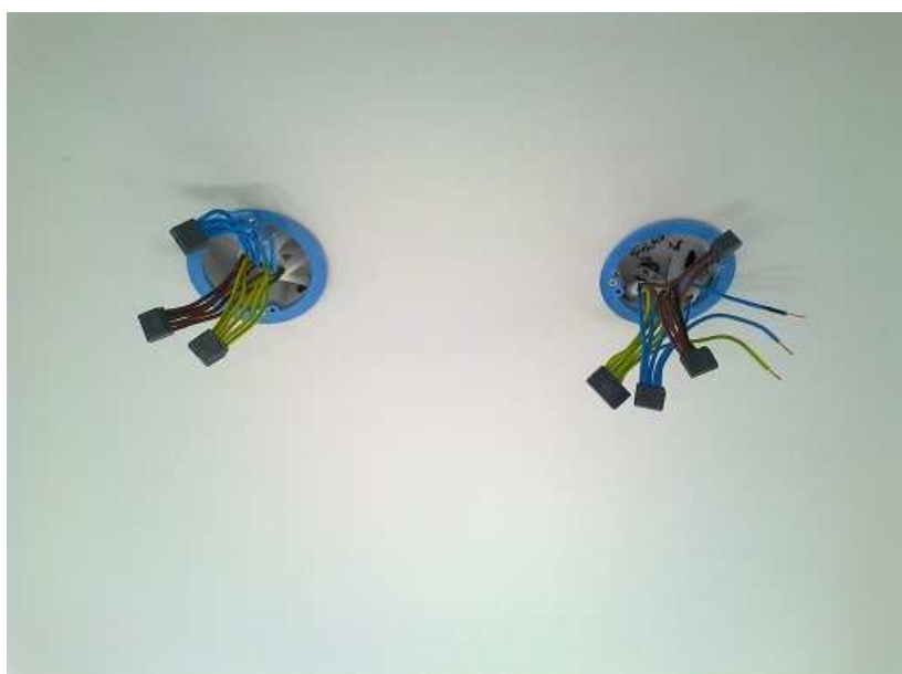
Kuva 7: Olohuoneen jakorasiat. Kyseiset jakorasiat ovat ns. karhukuppeja, joiden paikalleen saanti osoittautui melko hankalaksi kaapeleiden määrän vuoksi. Oikeanpuoleisen rasian irralliset johtimet olivat ripustuspeitekantta varten, jossa valaisinpistorasia.
