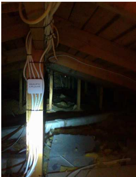
Kuva 2: Välikatolla kulkevat johdotukset. Jakorasiat ja kaapelit merkattiin hyvin tulevaisuuden remonttien varalle.
