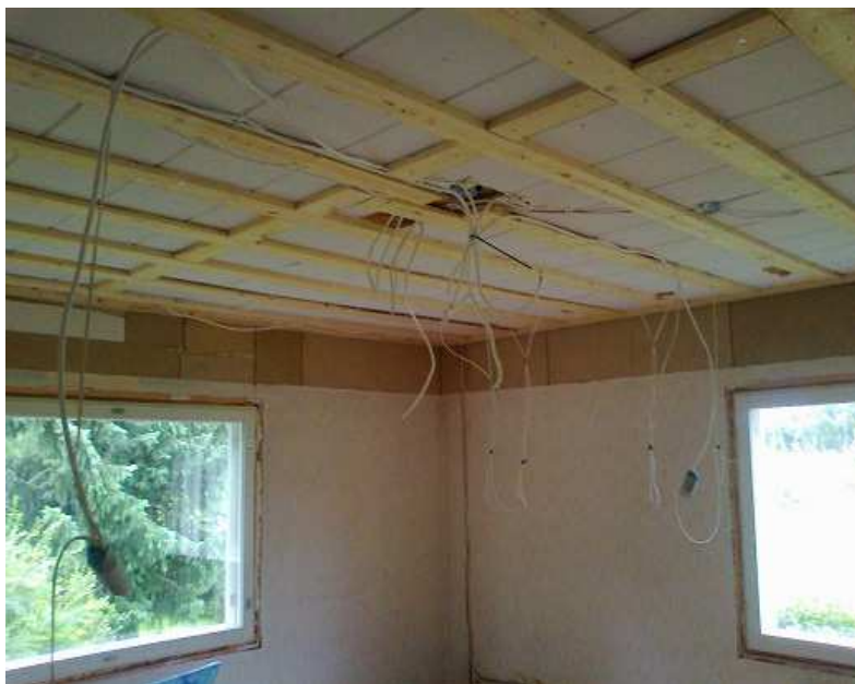
Kuva 6: Olohuoneen johdotusta. Kuvassa näkyvät LED-valojen muuntajat korvattiin lopulta yhdellä muuntajalla, joka sijoitettiin välikatolle.
