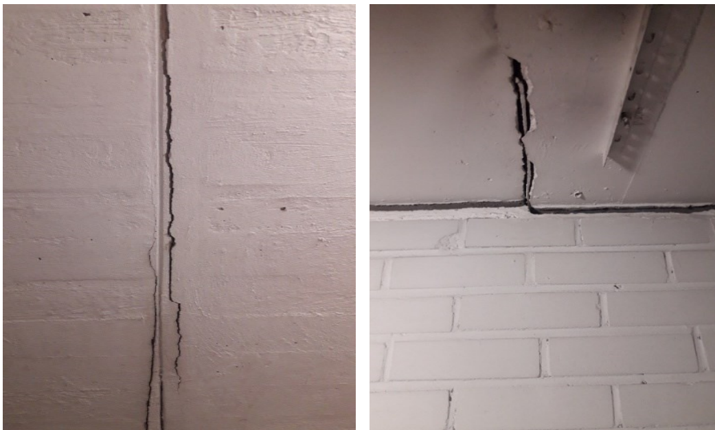
Kuvio 17. Halkeamia kohdekiinteistön rakenteissa
