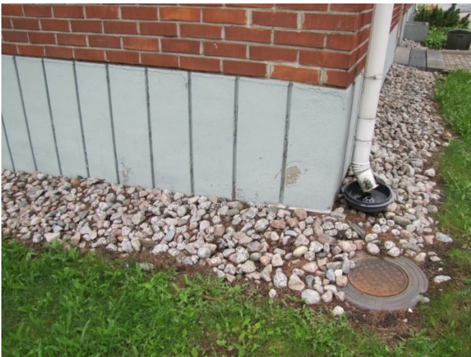
Kuva 7. Sokkelin maalipinnan paikkalohkeama
