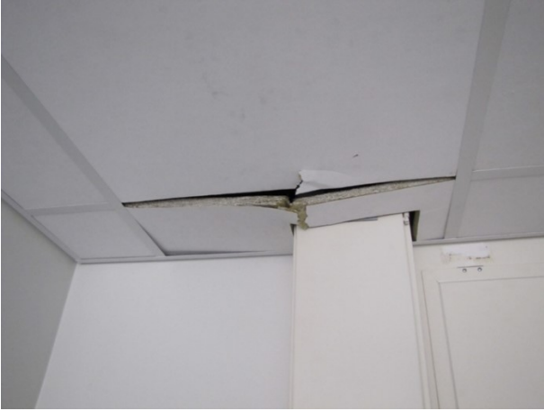
Kuva 25. Alakattolevyissä oli yksittäisiä korjaustarpeita.
