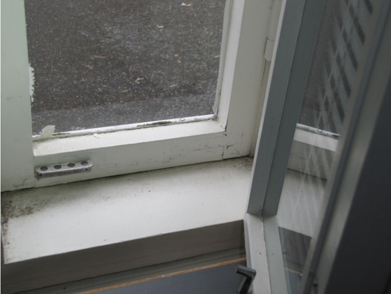
Kuva 12. Ikkunakarmit on huoltomaalattu. Työn jäljessä on puutteita ja maali on alkanut lohkeilla.
