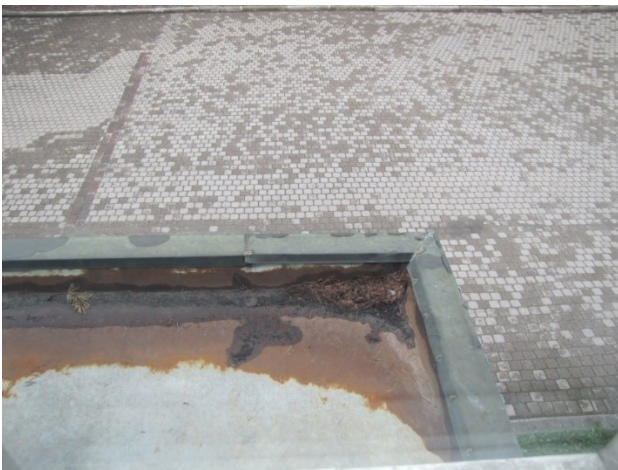
Kuva 18. Ovikatoksen kattopellitys on päässyt ruostumaan puutteellisen kosteudenpoiston seurauksena. Katolla oli irtoroskaa.
