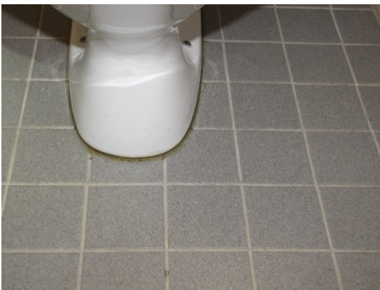
Kuva 28. Vesikalusteiden silikonisaumaukset ovat hapertuneet.
