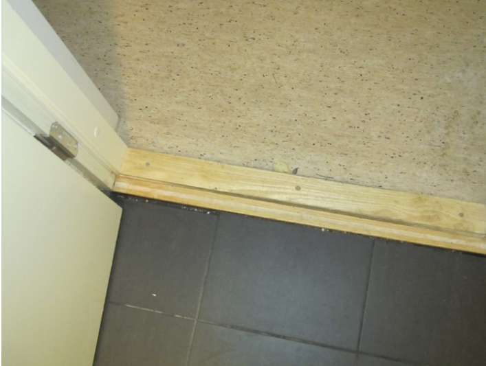
Kuva 23. Laattapinnoitteen yläreuna on samassa korossa kynnyksen kanssa.
