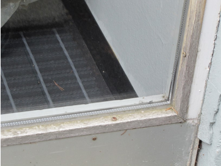
Kuva 14. Osa ikkunapuitteista on huonossa kunnossa.
