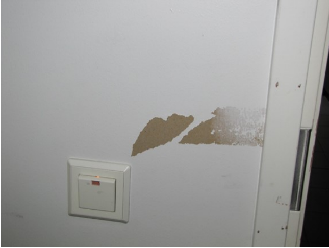
Kuva 20. Väliseinissä oli havaittavissa pieniä paikkamaalaustarpeita
