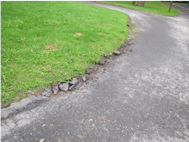
Kuva 4. Asfalttireunus oli osittain murtunut.
