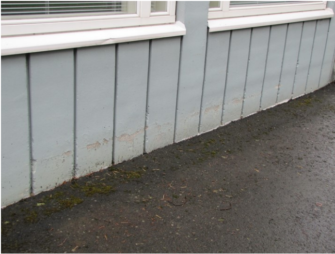
Kuva 6. Sokkelin maalipinnan linjamainen lohkeama
