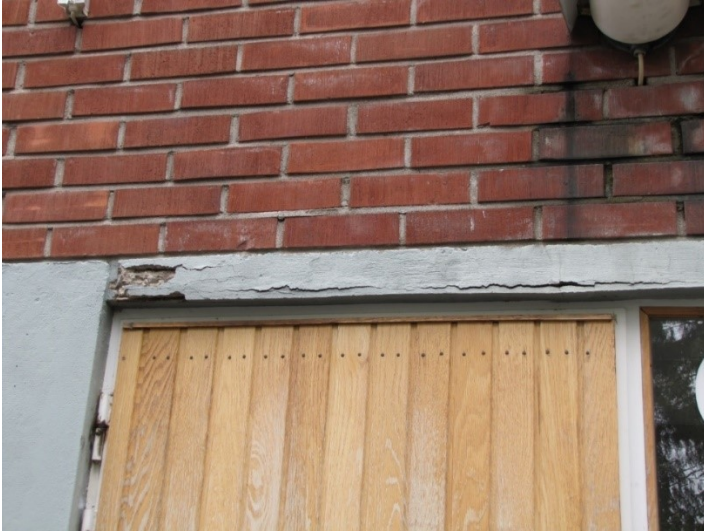
Kuva 8. Betonin pakkasrapautumaa idänpuoleisessa julkisivussa.
