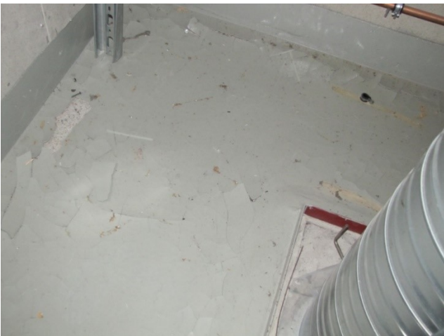
Kuva 26. IV-konehuoneen epoksilattiapinnoite on paikka paikoin halkeillut ja irronnut alustastaan.
