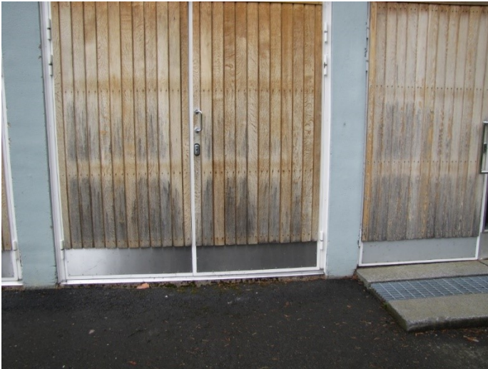
Kuva 16. Ulko-ovet ovat pinnoiltaan huonossa kunnossa.
