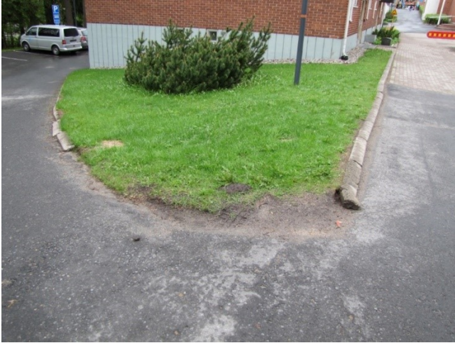
Kuva 3. Betonisia reunakiviä puuttuu.
