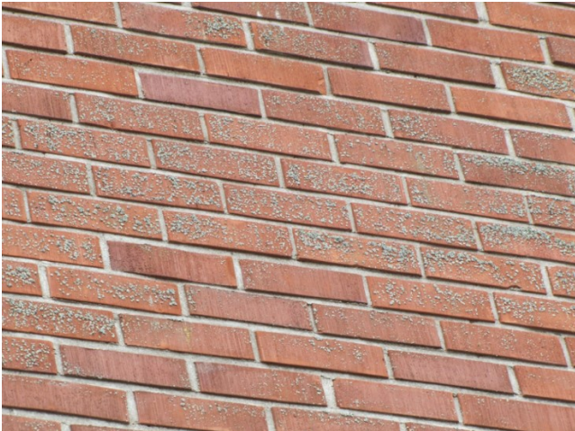
Kuva 10. Julkisivun pohjoisen puoleinen seinä on sammaloitunut.
