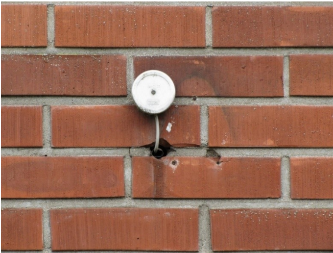
Kuva 11. Pohjoisenpuoleisen julkisivun tiivistämätön läpivienti.
