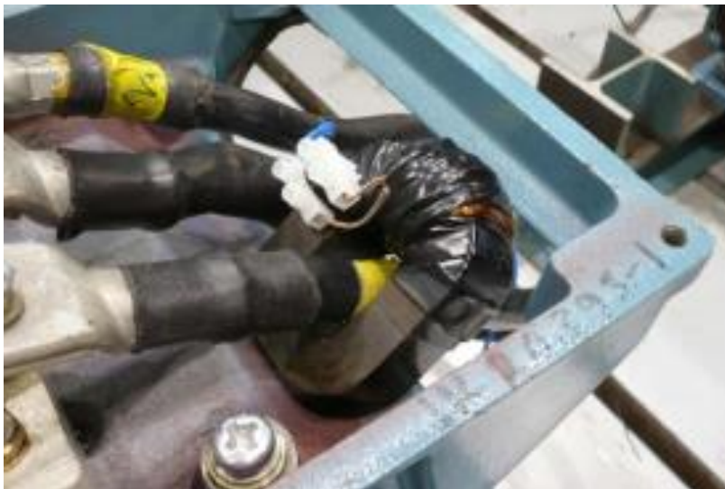
Kuva 6. Virtamuuntaja asennettuna moottorin vaihejohtimen ympärille. /7/
