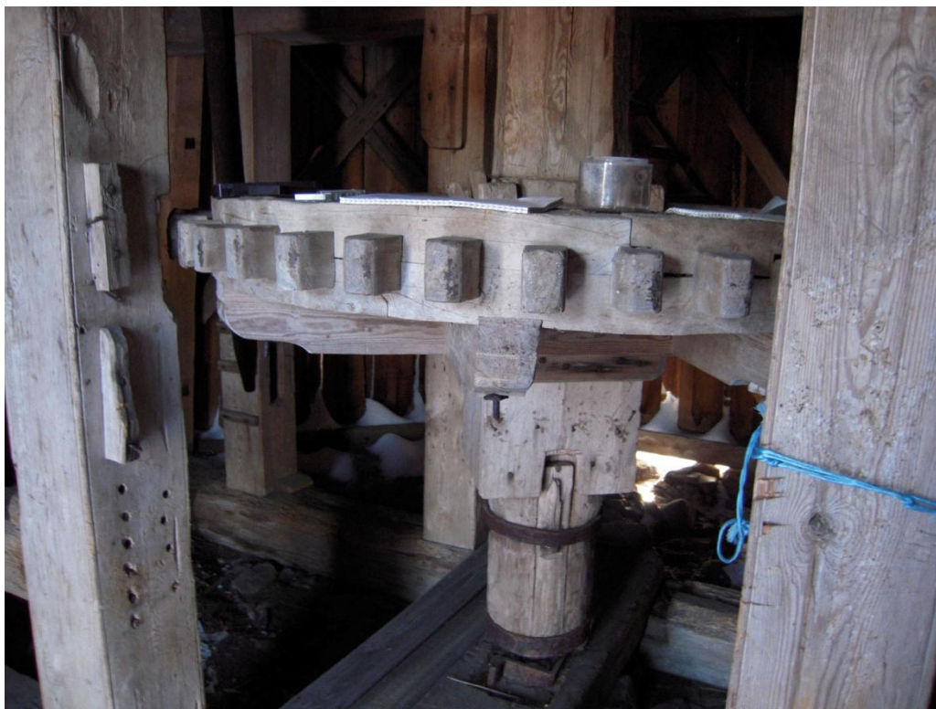
Pystyakseli hammaspyörineen ja kantavia pystypilareita.
