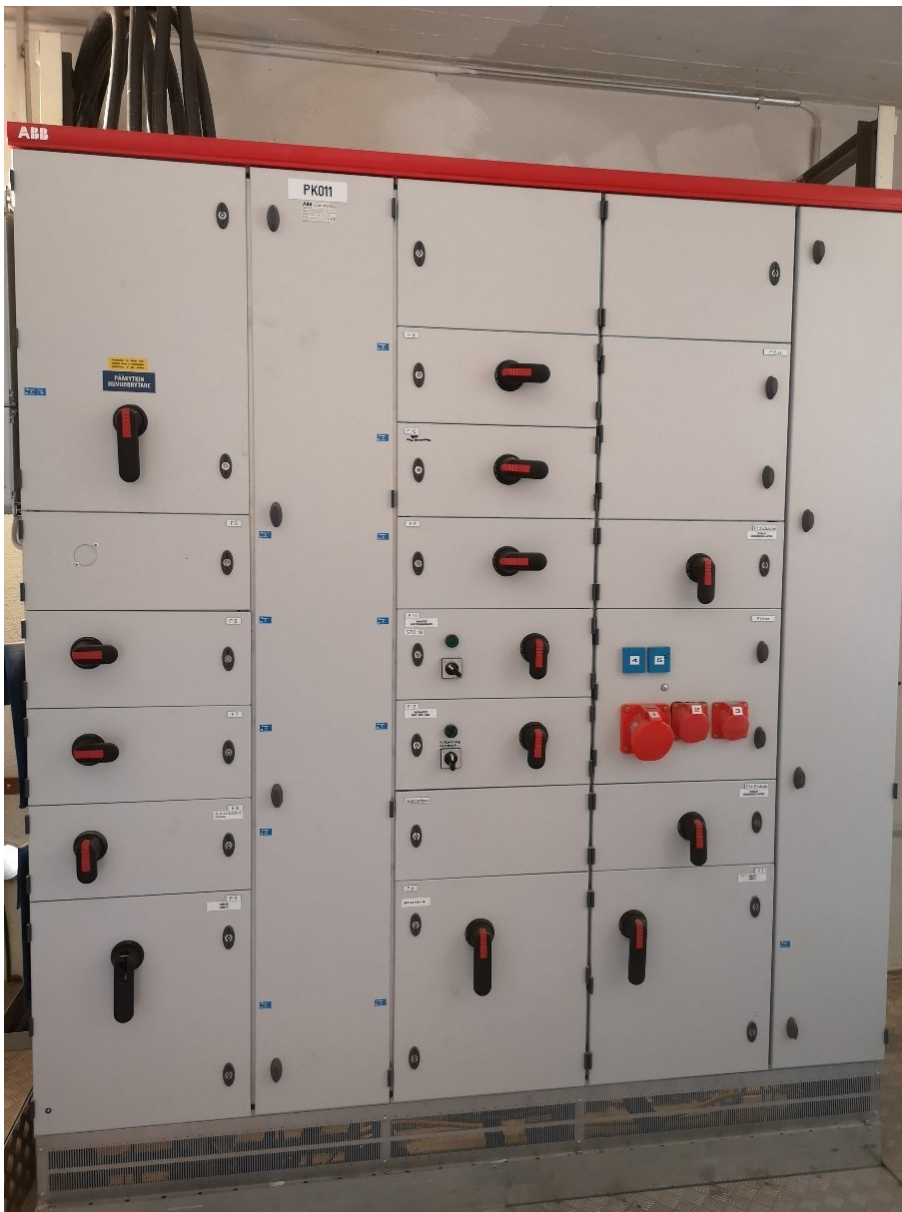
Kuva 5. Muuntamon MA1 sähköpääkeskus.
