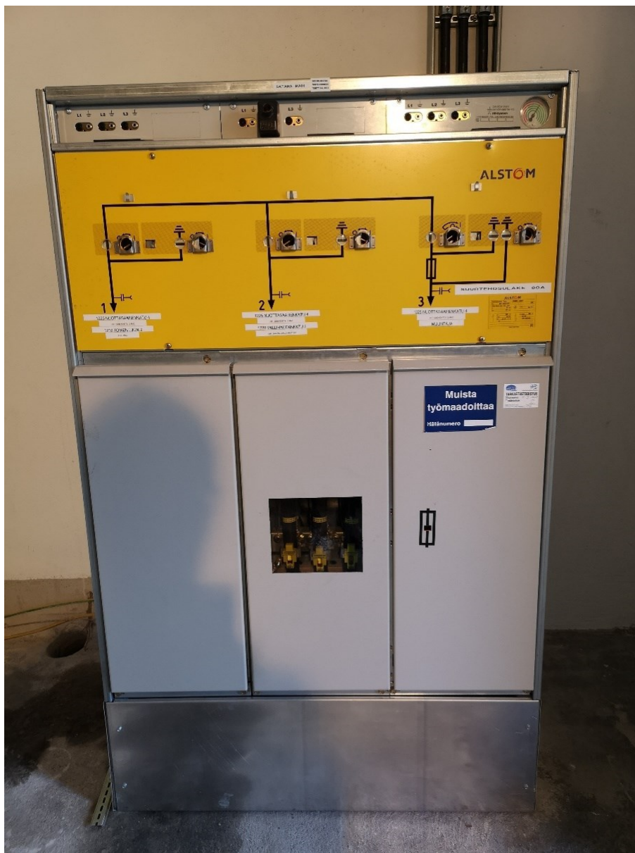
Kuva 2. Muuntamon MA1 10 kV keskijännitekojeisto.
