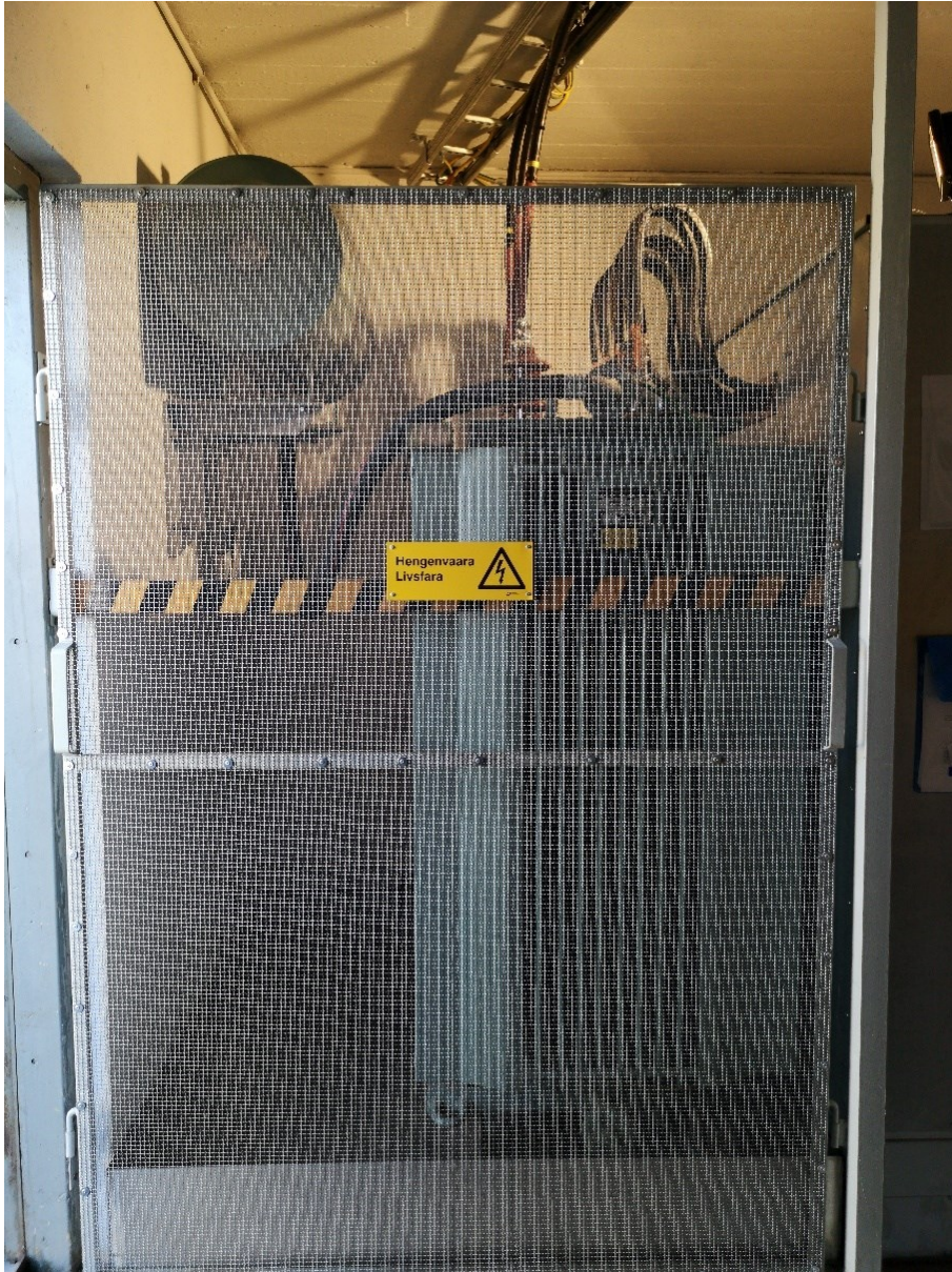
Kuva 3. Muuntamon MA1 muuntaja 300 kVA. Muuntaja sijaitsee kosketussuojatussa kennossa, johon ei pääsyä ilman työkalua.
