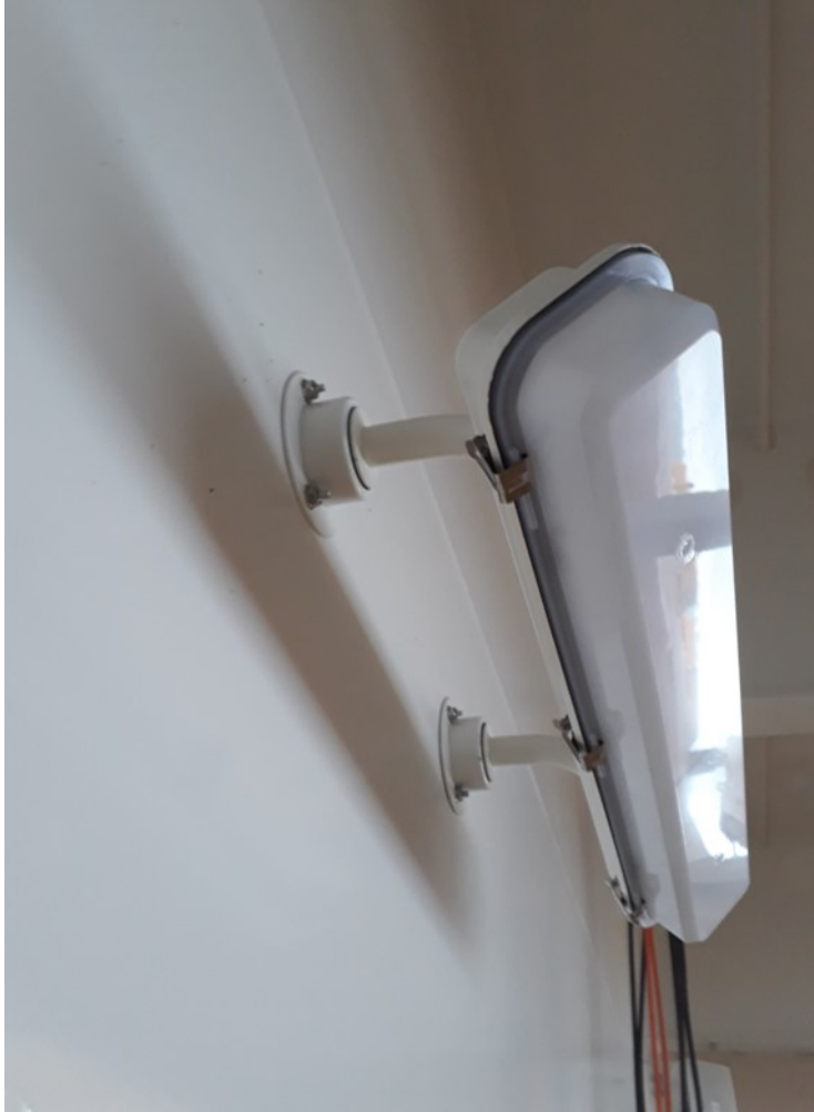
Kuva 7. LED-käytävävalaisin. (Meyer Turku Oy, 2021.)
