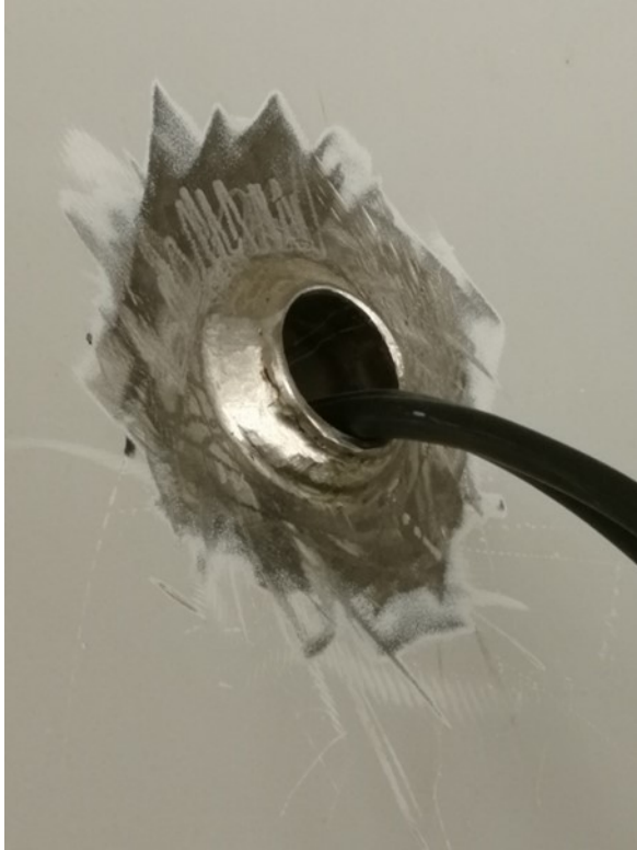
Kuva 10. Bollard-valaisimen sähköläpiviennin väärä asennustapa. (Meyer Turku Oy, 2021.)
