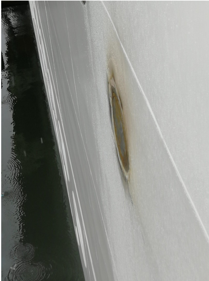
Kuva 13. Läpiviennin poistokohdassa oleva paikka, jonka halkaisija on 300 millimetriä. (Meyer Turku Oy, 2021.)
