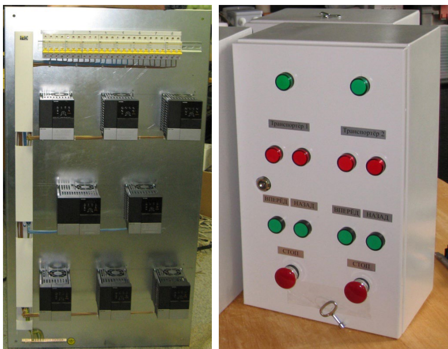
Фото 3. Шкаф управления частотными регуляторами
