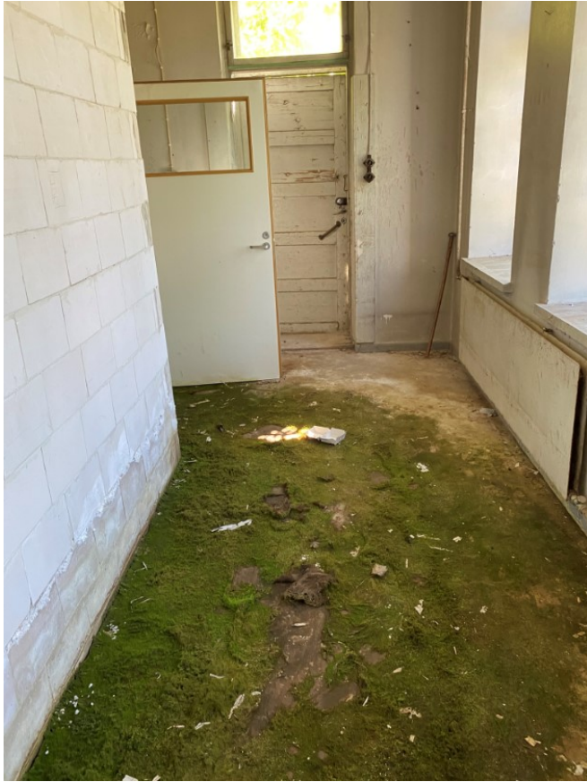
Kuva 9. Sammalkasvustoa betonilaatan päällä.
