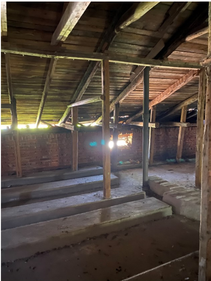
Kuva 7. Kosteus- ja mikrobivaurioitunut vesikaton puurunko.
