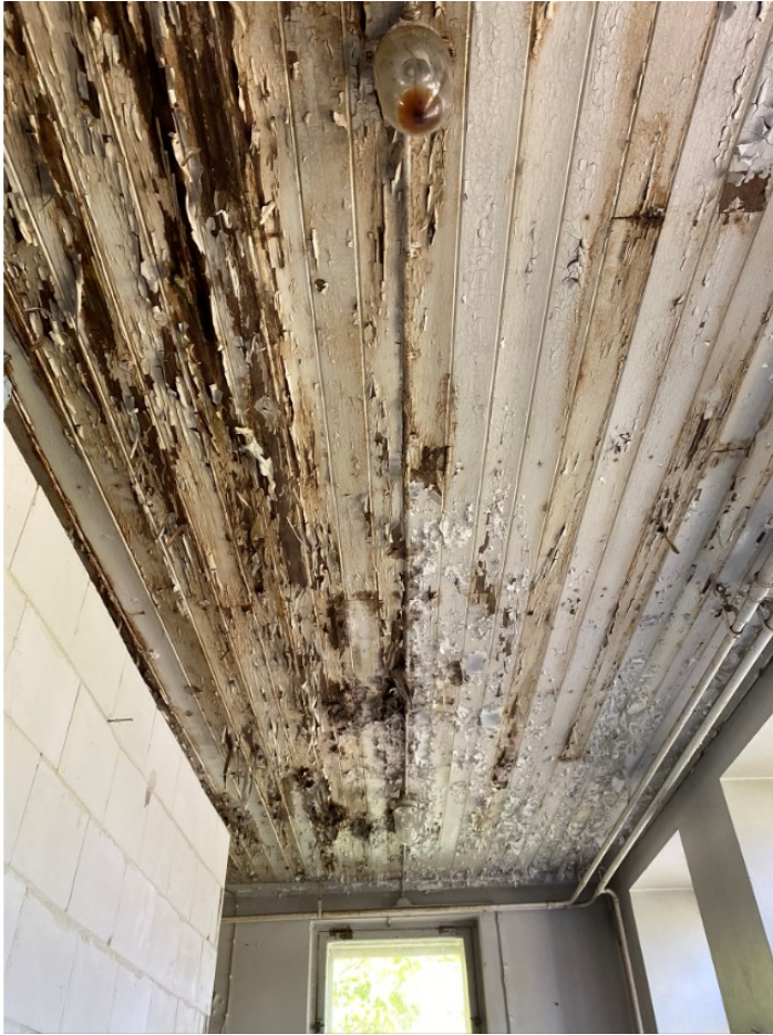
Kuva 18. Kuivaus- ja silityshuoneen kärsinyt kattorakenne.
