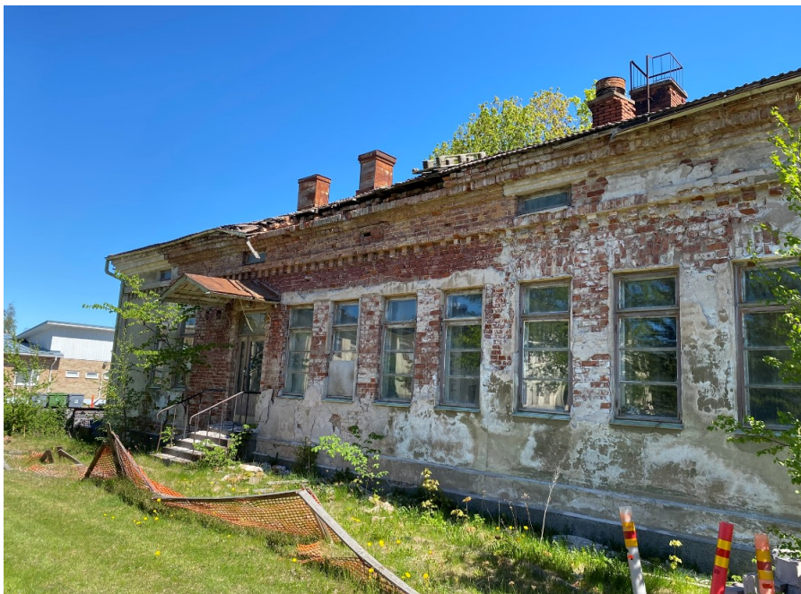
Kuva 11. Läntisen puolen julkisivu ja irtoillut rappaus.
