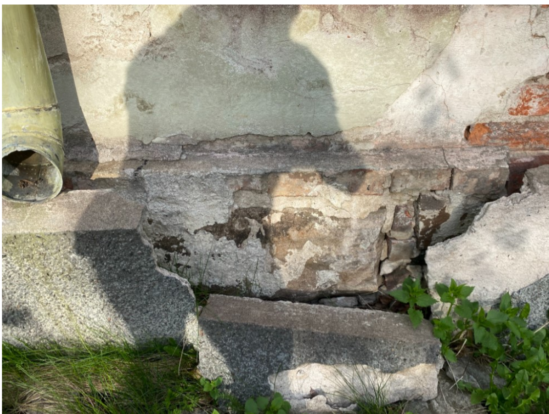
Kuva 8. Kivijalasta irronnut tasoite- ja rappauskerros.
