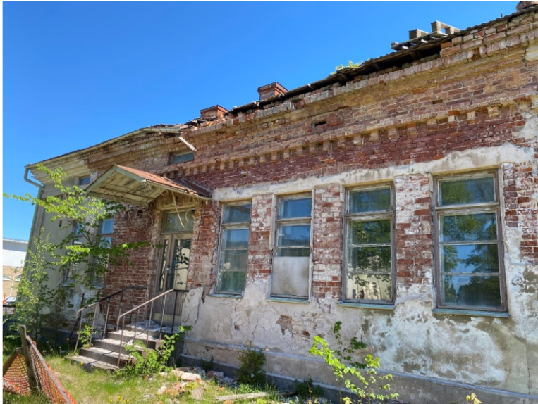
Kuva 6. Pahasti vaurioitunut räystäärakenne
