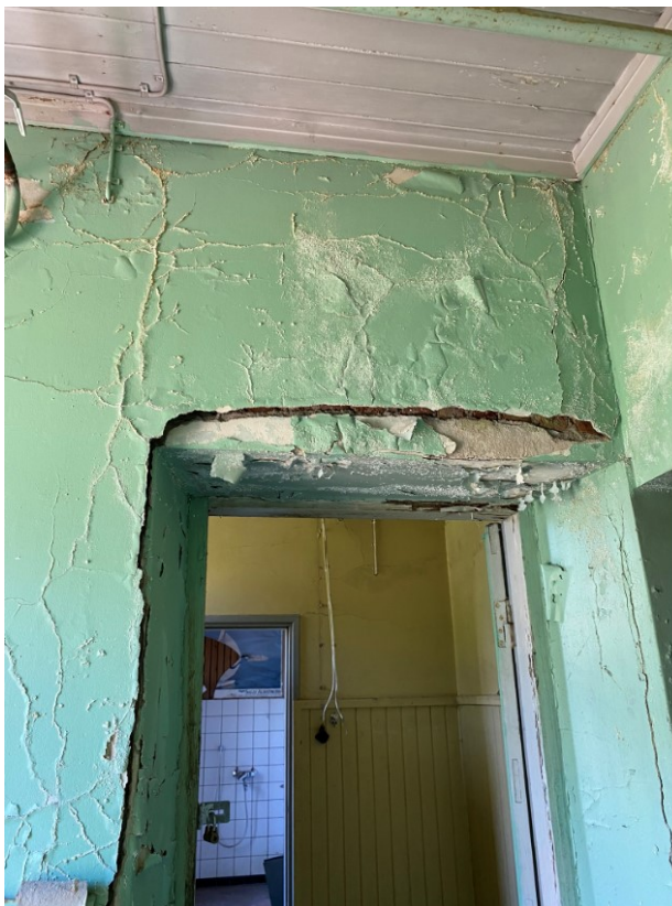
Kuva 17. Eteistilan irronneet rappaukset.
