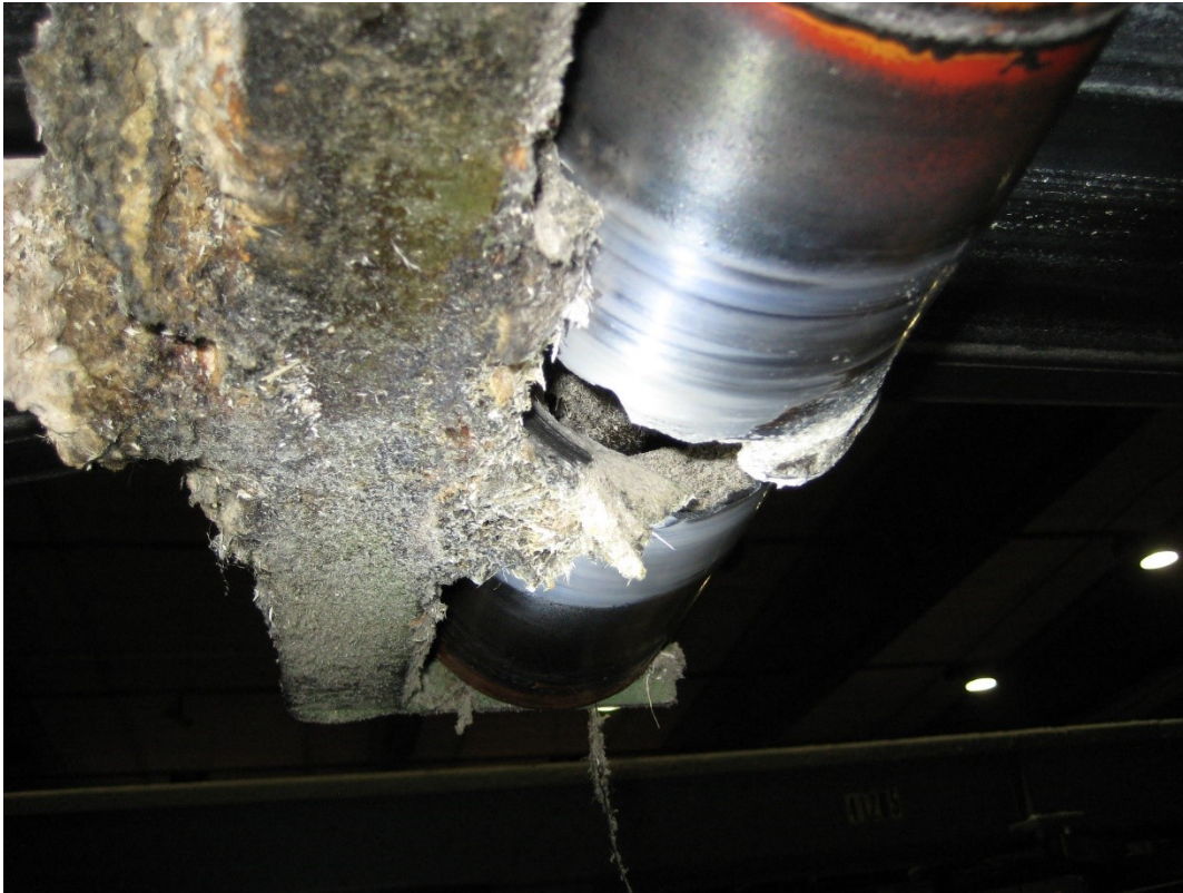
KUVA 11. Puhki kulunut rulla (7)
