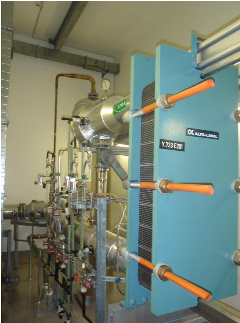
Kuva 4. Y.723 E201 lämmönvaihdin
