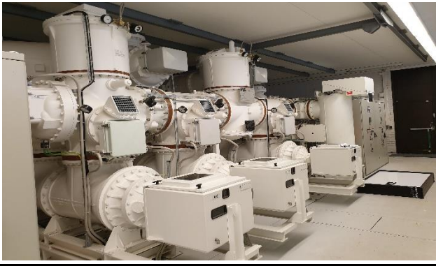
Kuva 1. Palkisentien 110/10 kV GIS-kojeisto
