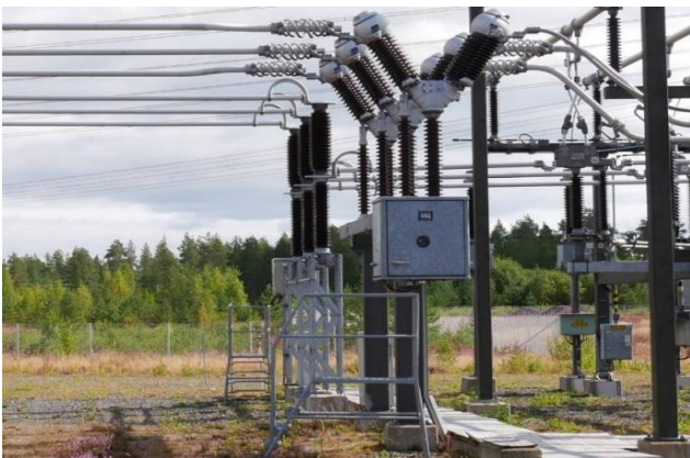
Kuva 1. 110 kV:n ilmaeristeinen ulkokytkinlaitos, vähäöljykatkaisija (edessä) ja SF 6 -katkaisija (takana)
