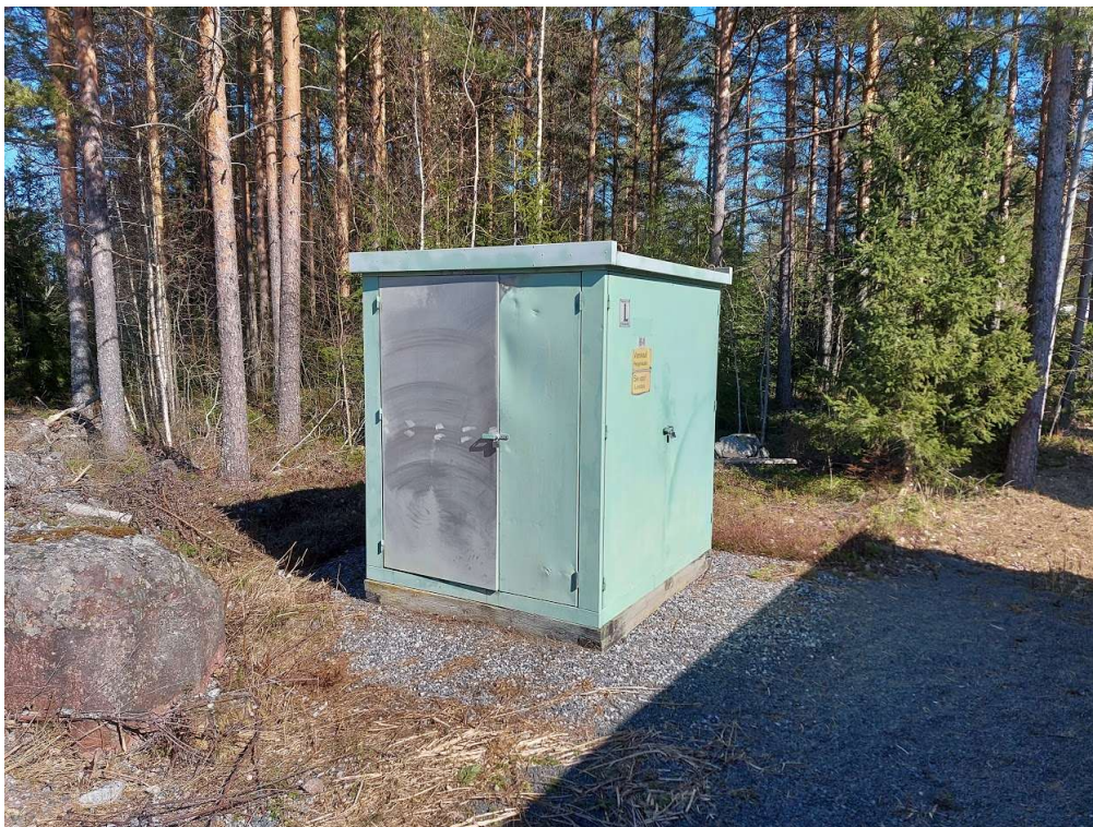
Kuva 7. Kompensointijärjestelmä sijaitsee lukitussa tilassa.
