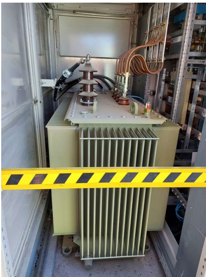
Kuva 6. 800kVA:n hermeettisesti suljettu muuntaja.
