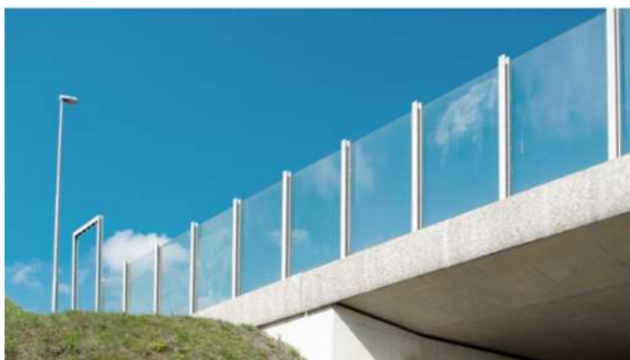
Kuva 4. Läpinäkyvä melueste (Väylävirasto julkaisuaika tuntematon).
