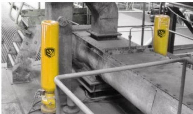
Kuva 6. Tukahdutuspanokset kuljettimen sivuilla (VST Engineering)
