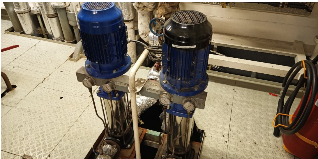
Kuva 12 Höyrykattiloiden syöttövesipumput (matkustaja-autolautta)
