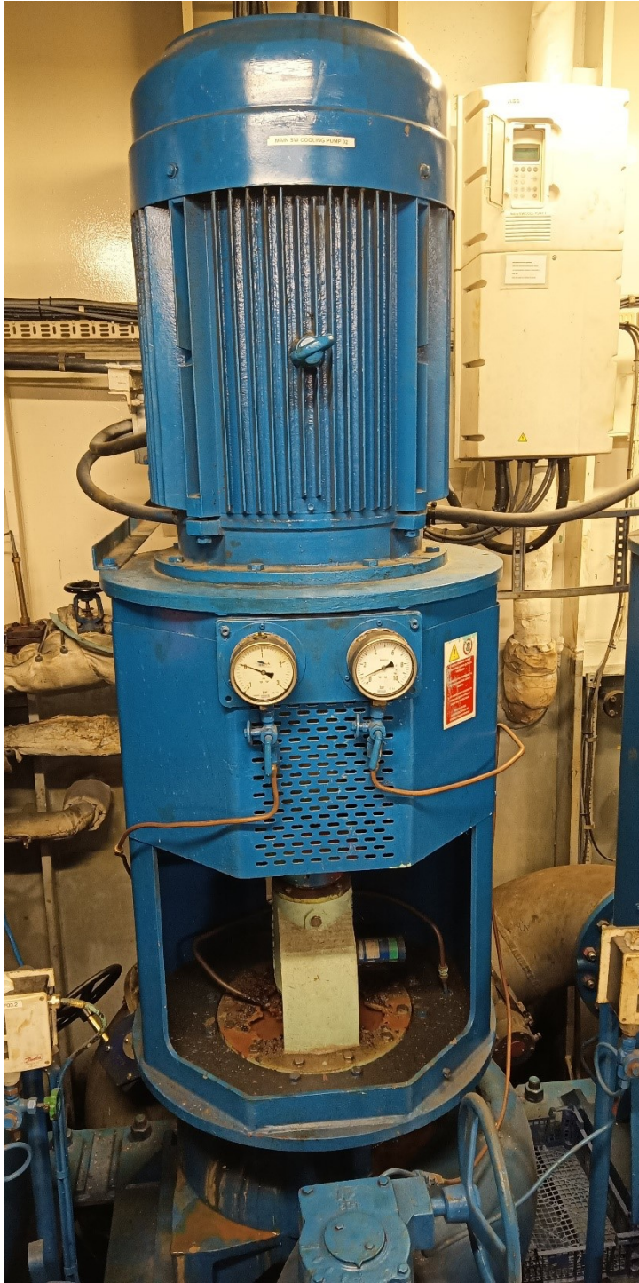
Kuva 11 Pääkoneiden merivesipumppu nro. 2 (matkustaja-autolautta)
