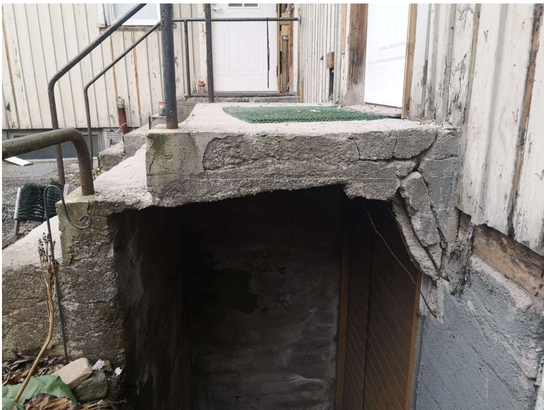
Kuvat 5 ja 6. Betoniportaiden huono kunto.
