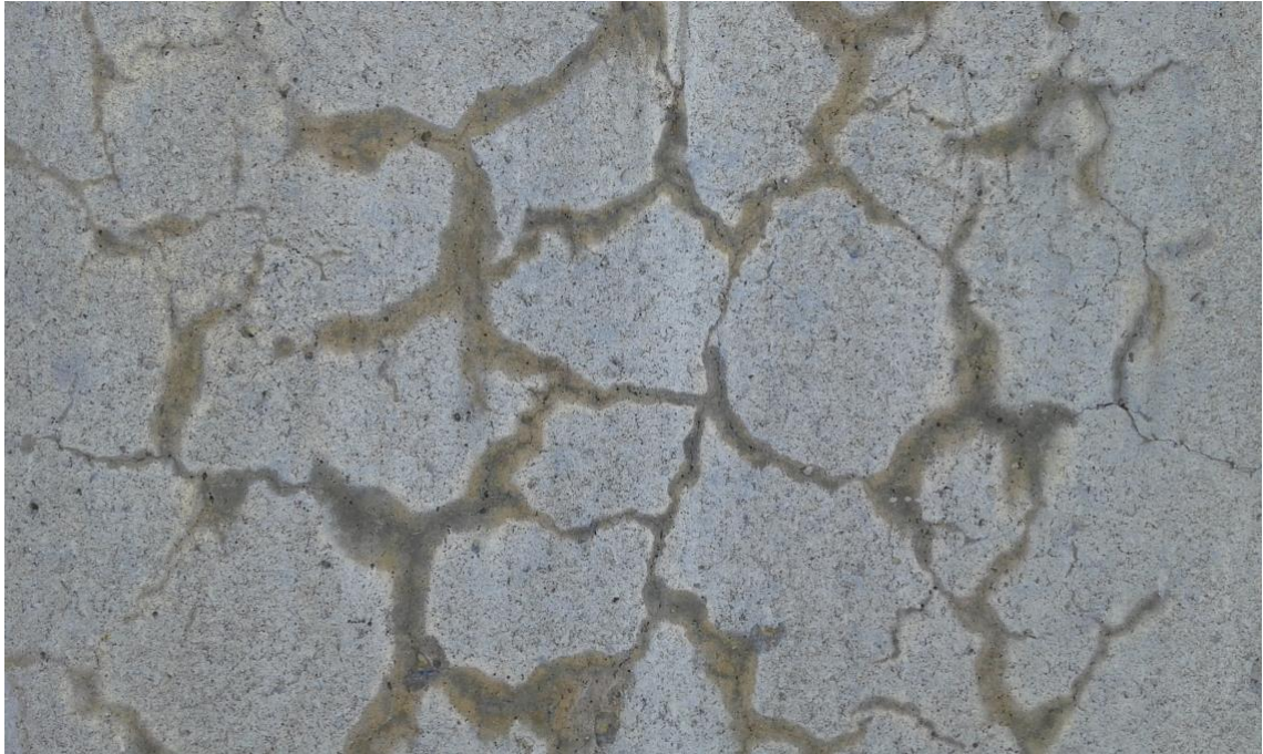
Kuva 9. Tyypillinen esimerkki alkali-kiviainesreaktion aiheuttamasta halkeilusta betonirakenteessa. Kuva: Amin K Akhnoukh.
