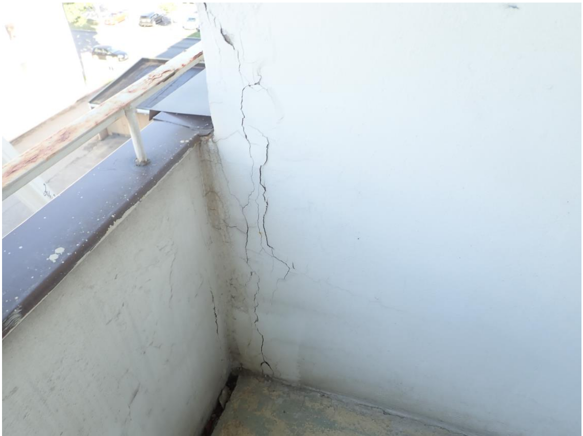
Kuva 7. Näkyvää pakkashalkeilua parvekkeen pieliseinässä. Kuva: Tommi Karihtala
