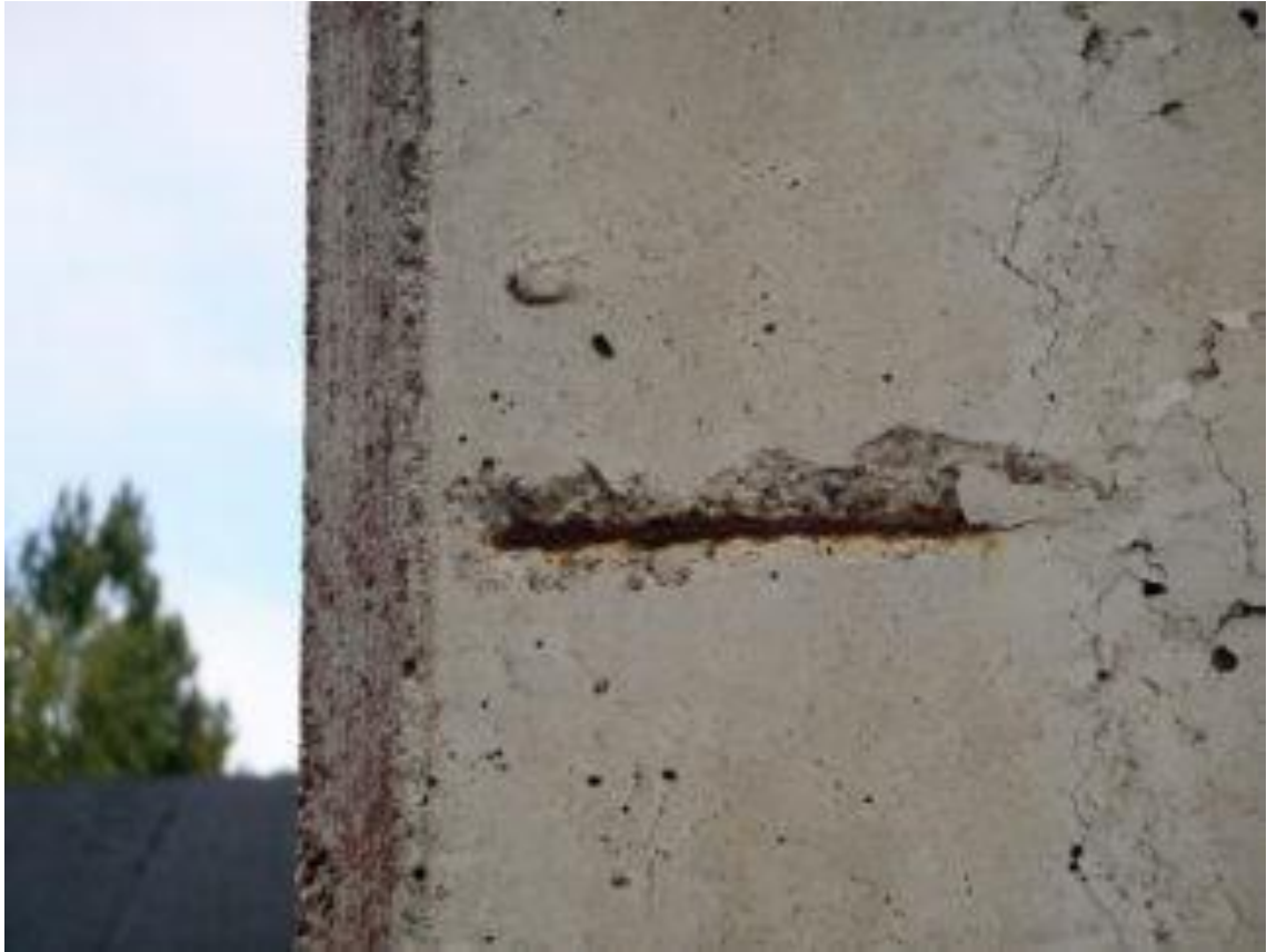
Kuva 6. Ruostunut betoniteräs on lohkaissut betonin pinnan. Kuvassa havaittavissa myös selvästi riittämätön betonin suojapeitepaksuus. Kuva: Betoni.com
