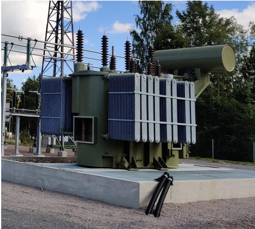
KUVA 10. TAKK:in sähkökentän muuntaja
