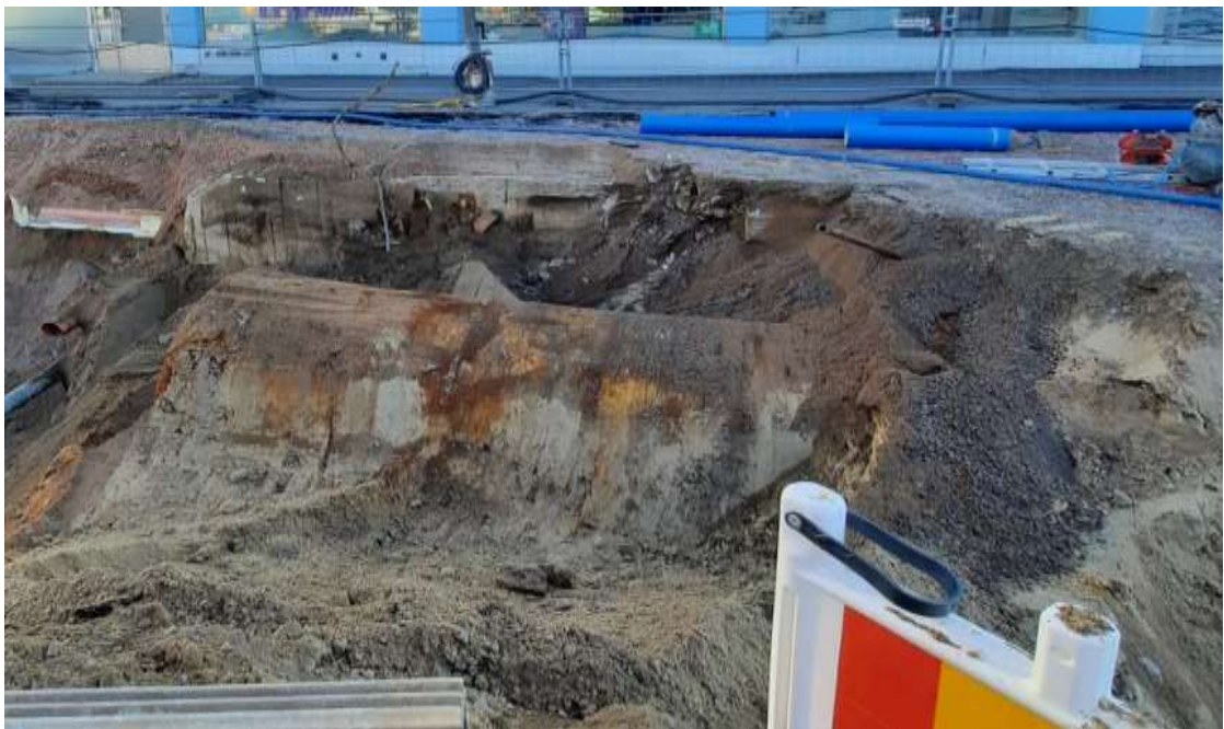
Kuva 13 Työmaalta löytynyt öljysäiliö
