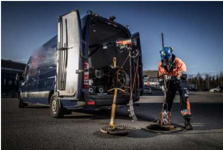
Kuva 11 Viemäreiden kuvausauto (Viemäryöt | Viemäriin avaus, viemäriin kuvaus ja viemäriin puhdistus (delete.fi.), Palm, Dan-Olof.)
