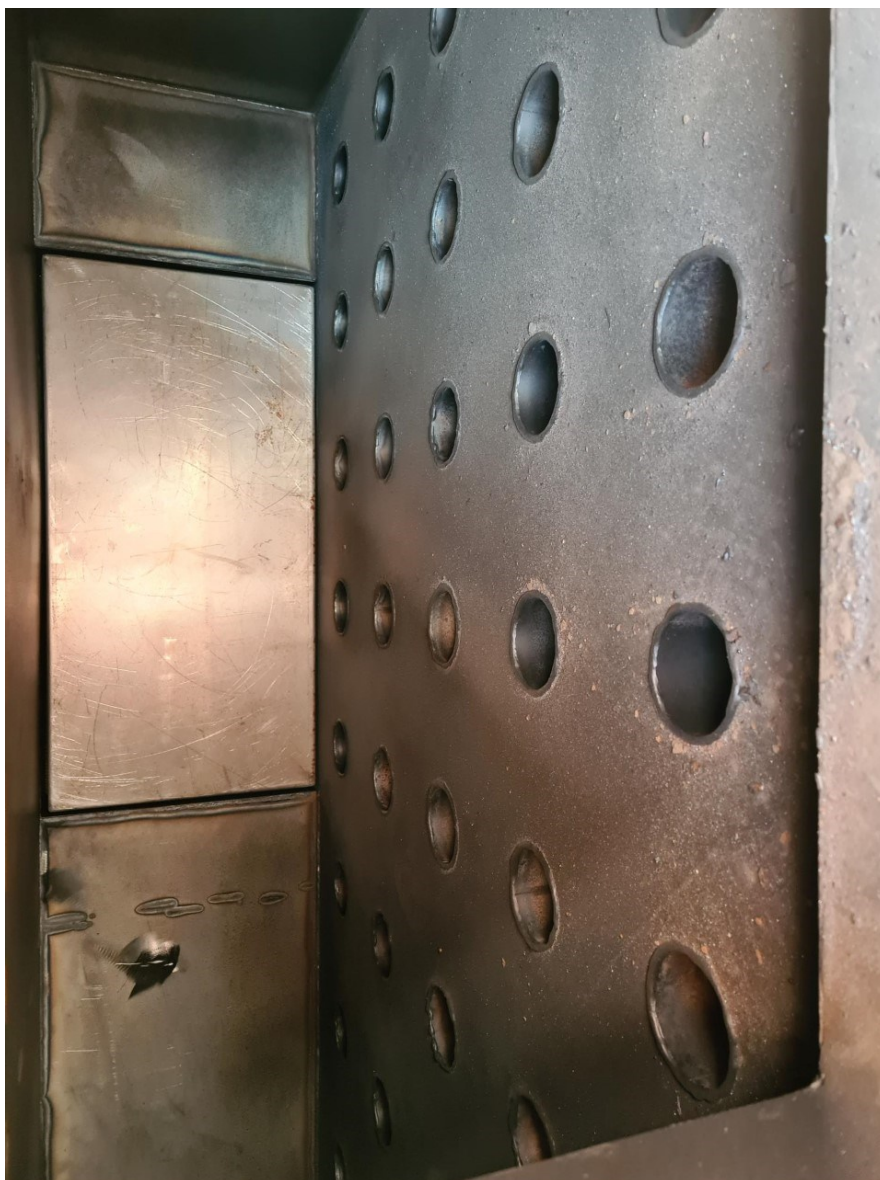
KUVA 13. Puhtaan savukaasun kammio; kuvassa keskimmäisen levyn takana on puhtaan savukaasun poistokanava
