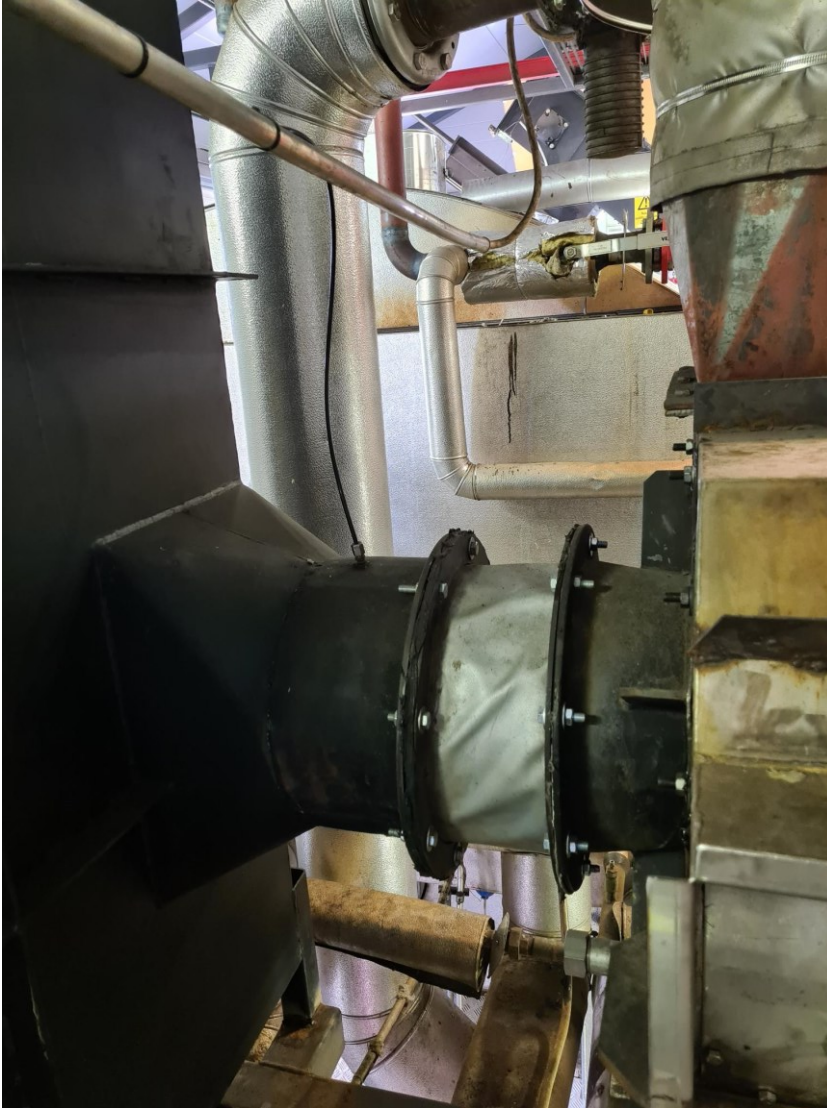
KUVA 16. Multisyklonin ja puhtaan savukaasukanavan liitoskohta
