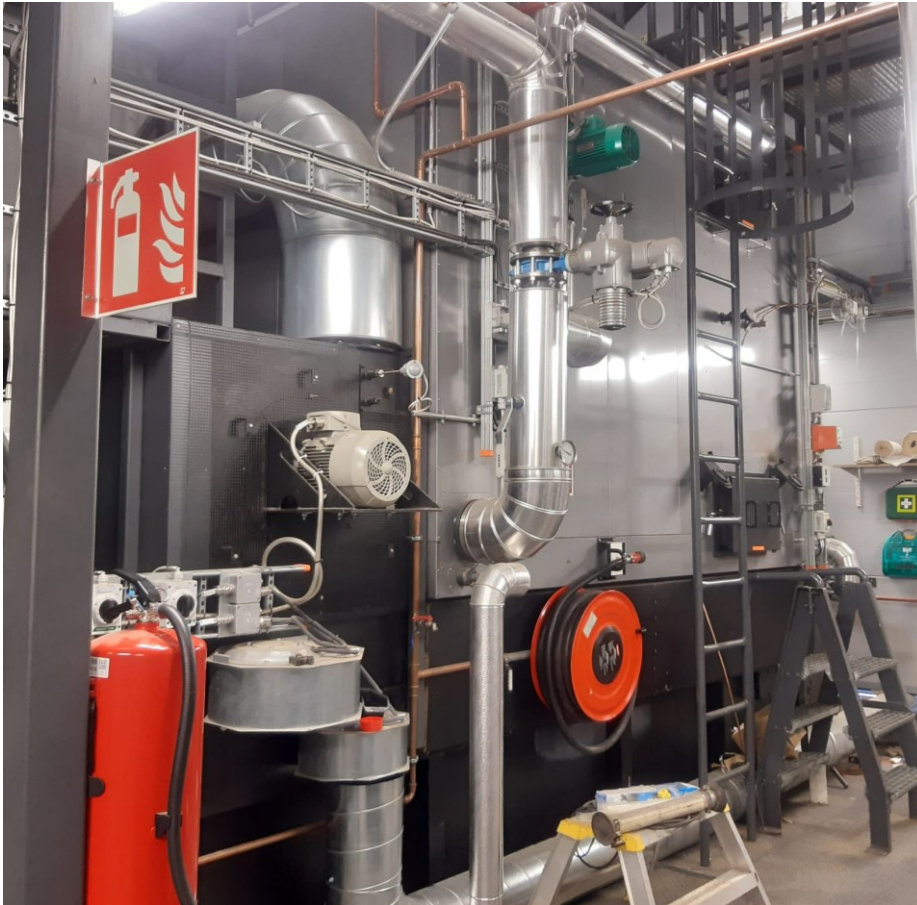
KUVA 5. Kärsämäen kaukolämpölaitoksen pellettikattila
