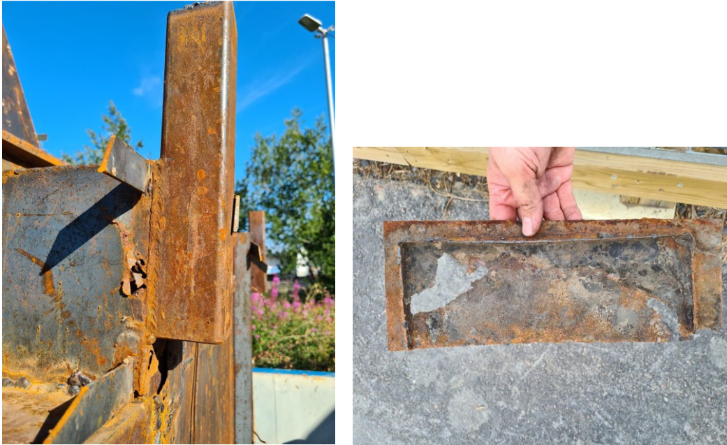
KUVA 11. Multisyklonin jakokammion alaosa on ruostunut pahoin puhki
