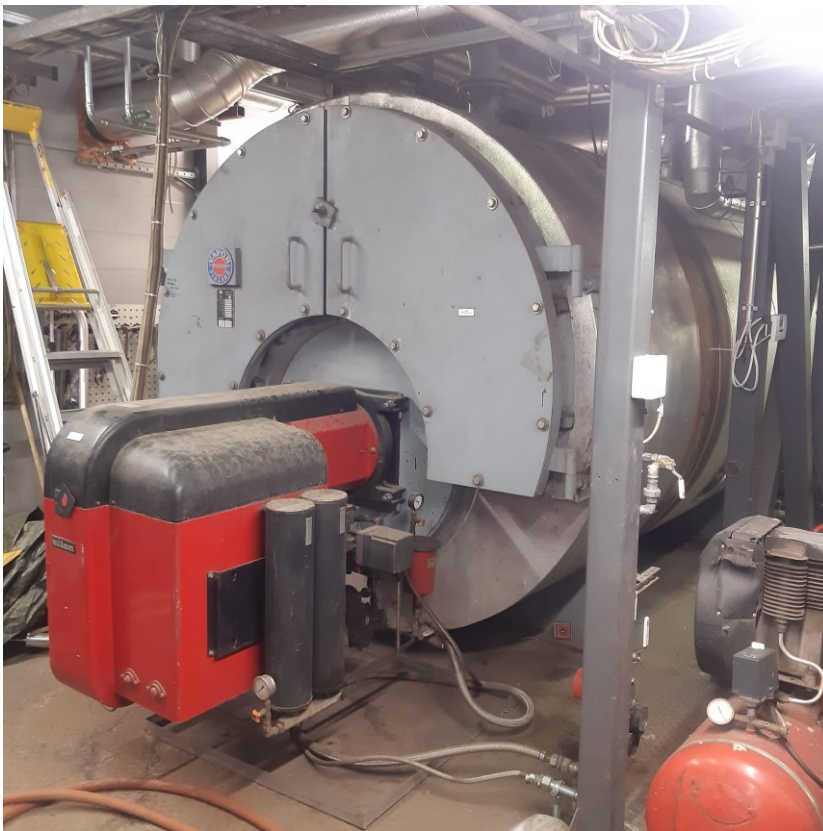
KUVA 4. Kärsämäen kaukolämpölaitoksen öljykattila
