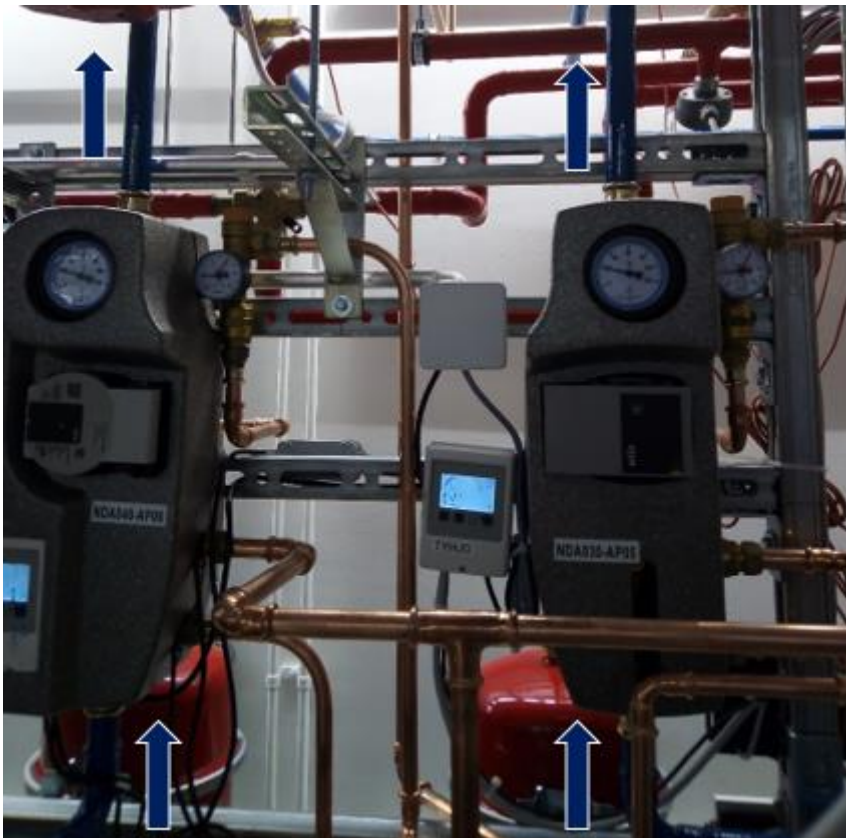
Kuva 4 Taso- ja tyhjiökeräinten pumppuyksiköt
