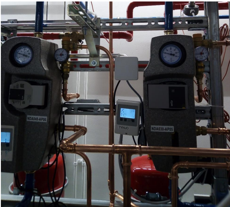
KUVA 9. Taso- ja tyhjiöputkikeräinten pumppuyksiköt
