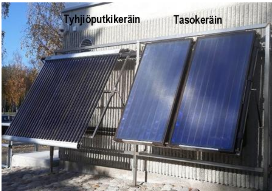
Kuva 3. Aurinkokeräinjärjestelmän tyhjiöputki- ja tasokeräimet (15)
