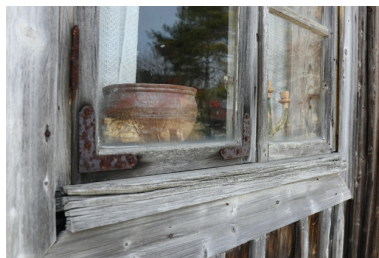
Ikkunoiden maalipinta on lähes kauttaaltaan kulunut pois
