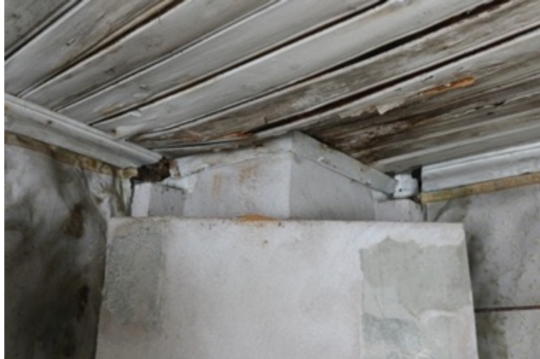
Kuva 43. Tupakamarin laipion vaurioita huonetilan puolelta (Lindholm 2021)
