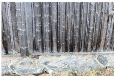
Itäsvun ulkoverhousessa ei juurikaan sahausjälkiä näy
