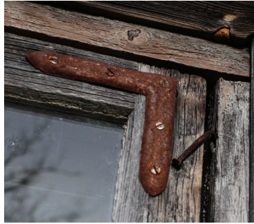
Tupakamarin eteläpään ikkunan kulmarauta 1930 →
