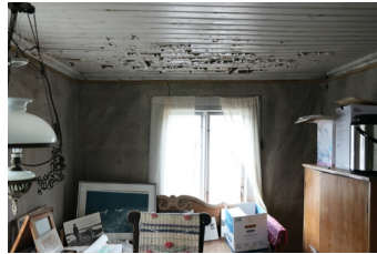
Kamarin laipion pihan puoleinen vauriokohta
