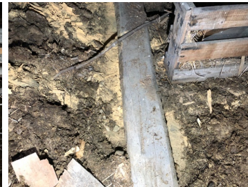
Yläpohjan niska vauriokohdassa
