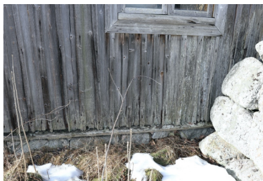
Itäsvun pohjoispään ulkoverhouksen vaurioita
