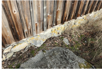
Eteläpään alahirsessä on lahovaurio
