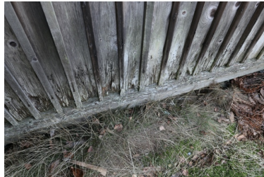
Kuistin ulkoverhouksen vaurioita
