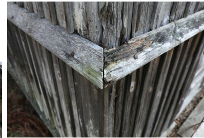
Kuistin luoteiskulman vesilistarakennetta
