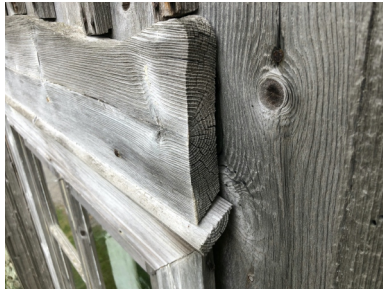
Ikkunoiden yläpuoliset koristelistat ovat paikoin 32mm paksuja
