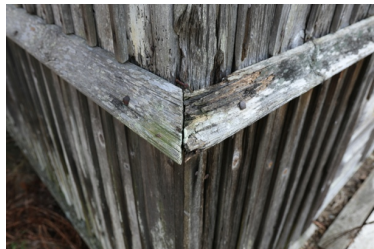
Kuistin vaakavesilistan vaurio
