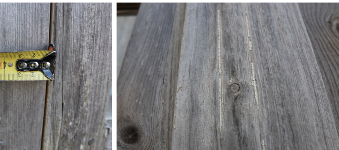
Ikkunoiden vuorilistoissa näkyy paikoin maalijäämiä
