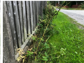
Pohjoissivun ulkoverhaus on paikoin lahonnut alapäästä
