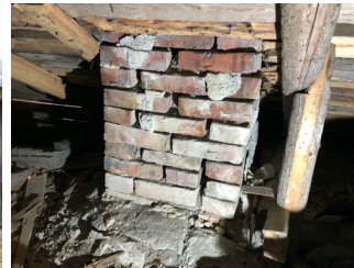
Piiput ovat huonossa kunnossa vintin osuudella
