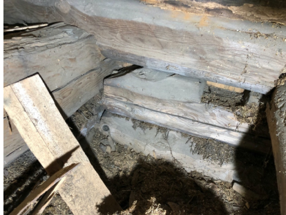
Tupakamarin eteläpäädyn hirsissä näkyy loivemmasta kattokulmasta viite
