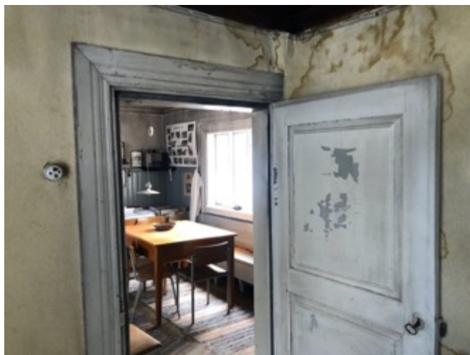
Kuva 49. Vanhoja katon vuodon jälkiä porstokamarissa (Lindholm 2021)
