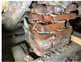
Pahoin rapautuneita tiiliä päätykamarin piipussa
