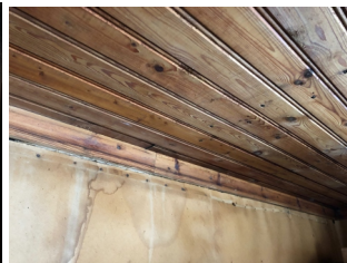
Seinissä näkyy vanhoja kosteusvaurion jälkiä
