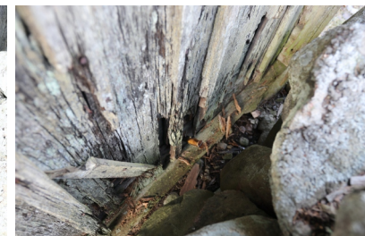
Itäsvun pohjoispään alahelman vaurioita
