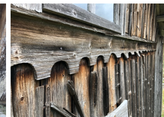
Eteläpään tasakerran lehtisabalistan vauriot
