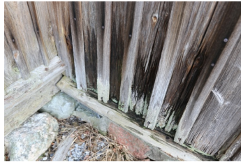
Länsiseinän ja kuistin välisen nurkan vaurioita
