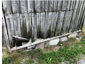
Länsipään ulkoverhouksen vaurioita
