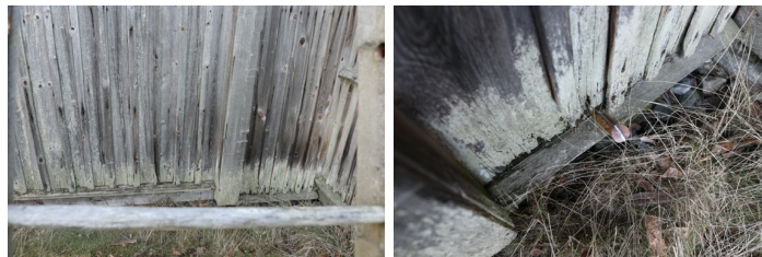
Länsiseinän kuistin ja seinän pohjoispään sisänurkan lahovauriota
