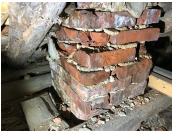
Kuva 50. Piippujen tiilet ovat paikoin niin pahoin rapautuneita, että piiput uhkaavat vähitellen sortua (Lindholm 2021).
