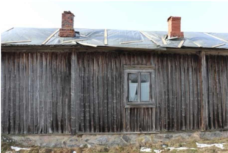
Kuva 45. Pärekatto vuotaa useasta kohtaa, ja se on uusimisen tarpeessa (Lindholm 2021).
