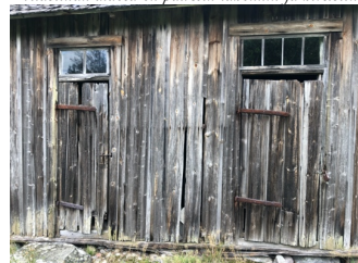
Eteläseinän ulkoverhouksessa on reikiä
