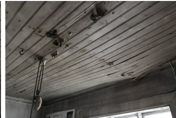
Osin labonnutta kattopanelointia
