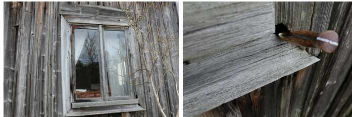
Tupakamurin länsiseinän ikkunan alakulman lahovaurion pääsi toteamaan listojen välisestä reiästä
