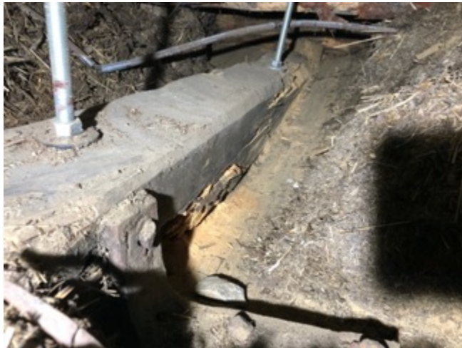
Kuva 42. Tuvan laipion vaurioita vintiltä kuvattuna (Lindholm 2021)
