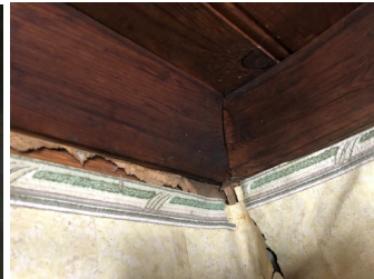
Seinäpaperoinnit ovat paikoin revenneet
