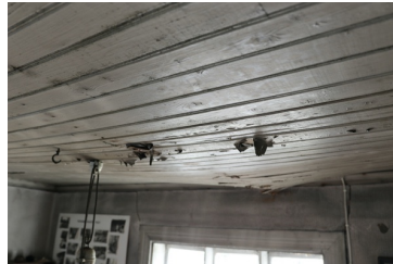
Tuvan puolelta yläpohjan vauriokohta
