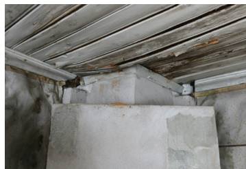
Piipun juuren vauriokohta
