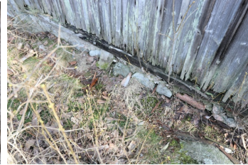
Länsiseinän ulkoverhouksen alapään vaurioita
