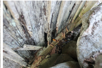
Itäseinän pohjoispäässä on pitkälle edennyt lahovaurio
