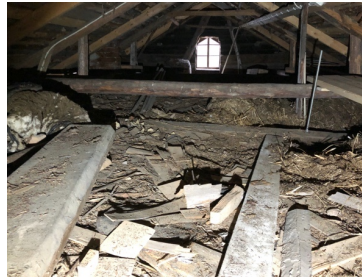
Kuvan keskellä päästä labonnut ja painunut laipion ansas
