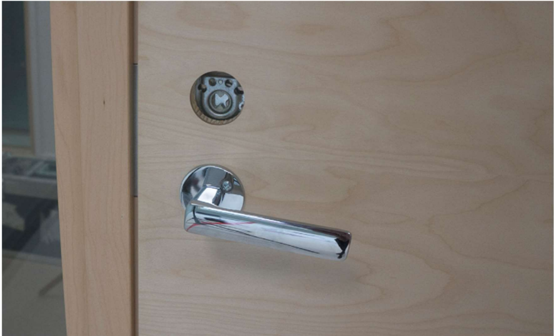
Kuva 7. Ovien lukoista puuttuu helat.
