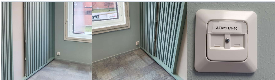
Kuva 9. Valokuvat pistokkeista, joissa havaittiin äänivuotoja.
