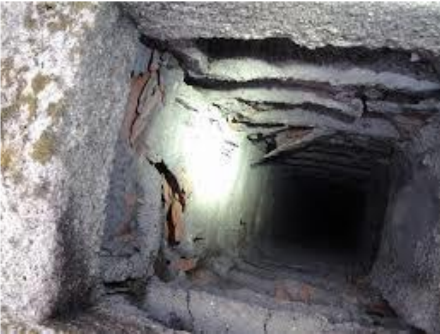
Kuva 1. Huonokuntoinen savupiippu (Hormimiehet.fi)
