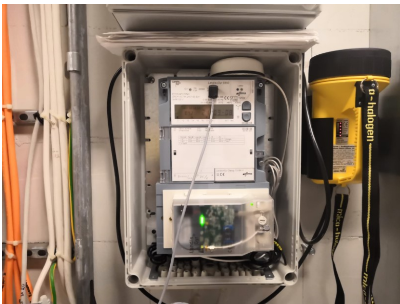
KUVA 1. TAMKin sähköpäämittari muuntamotilassa
