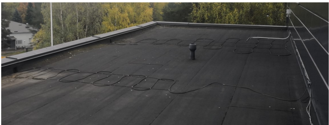
KUVA 11. Kattolämmityksiä C-talon katolla
