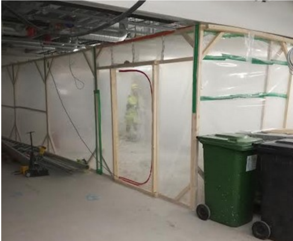
Kuva 5 Alipaineistettu työtila P1-puhtausluokan alueella
