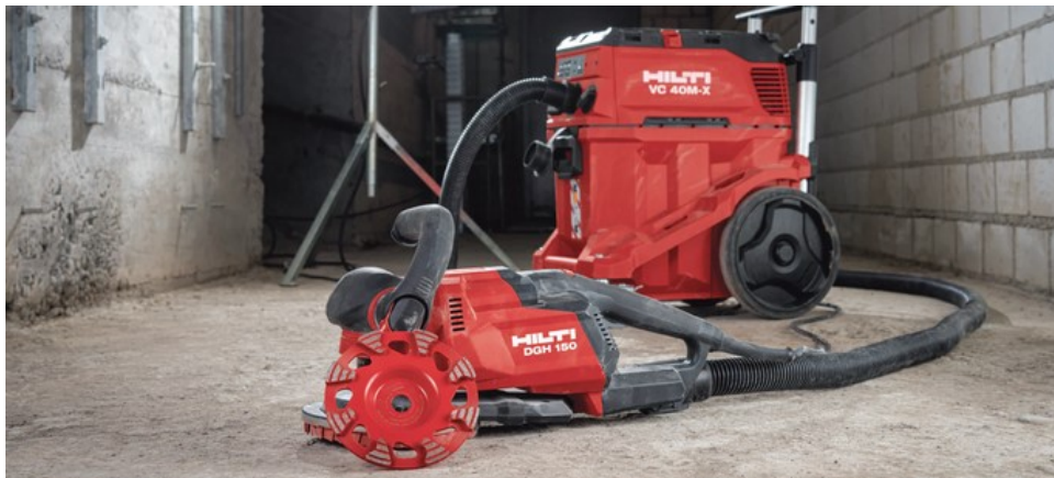
Kuva 4 Laitekohtaisella poistolla varustettu betonin hiomakone [14].
