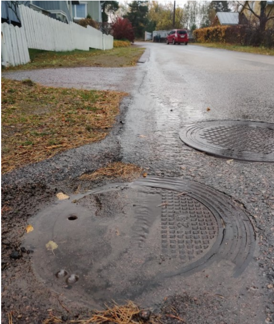
Kuva 2. Jätevesiviemäriin reiällinen runkokaivon kansi kerää asfalttia pitkin valuvat sadevedet (Rantavuo 2021)
