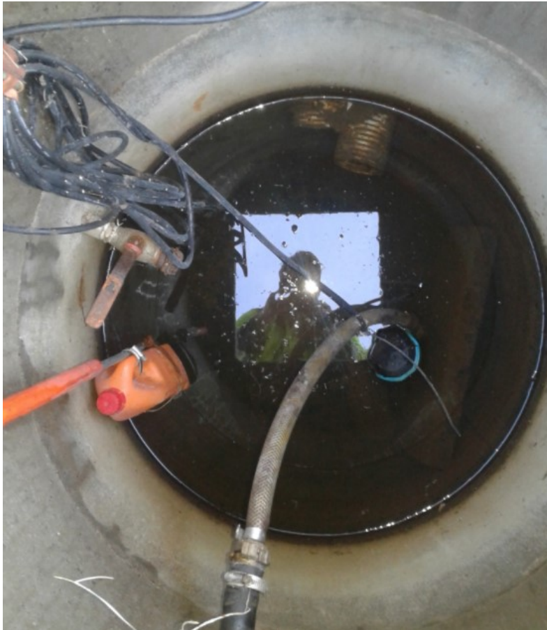
Kuva 21. Kiinteistön hulevesikaivoon on asennettu pumppu, joka pumppaa huleveden jätevesiviemäriin tarkastuskaivoon (Rantavuo 2021)
