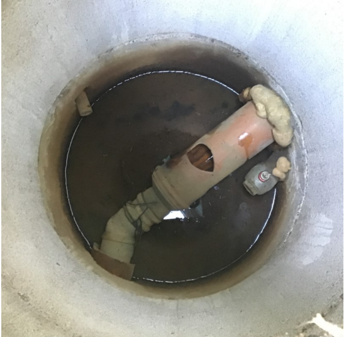
Kuva 18. Kiinteistön kaivossa viemärin selkään on tehty reikä pohjaveden kuivumista varten. Kaivoon johdettu lisäksi salaojaputki ja ilmeisesti viemärin huuhtelua varten palloventtiilillä varustettu vesijohto (Rantavuo 2021)
