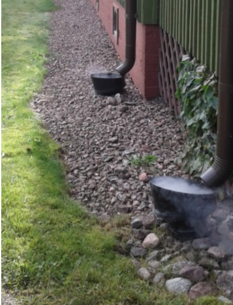
Kuva 16. Kiinteistön rännikaivot kytketty jätevesiviemäriin (Rantavuo 2021)
