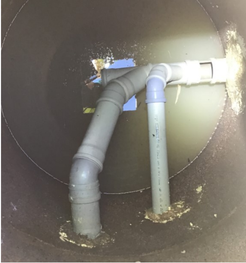
Kuva 19. Kiinteistön betonikaivossa viemärin selkä on jätetty auki, jotta pohja- ja sulamisvesi pääsee vuotamaan viemäriin (Rantavuo 2021)
