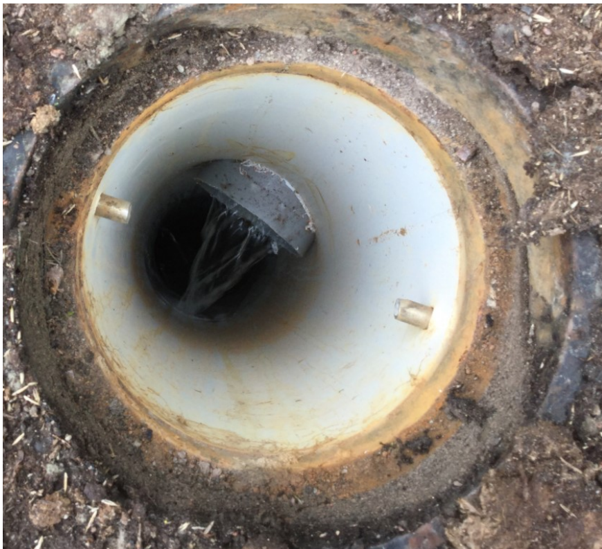
Kuva 17. Kiinteistön rännikaivojen liitos jäteveden tarkastuskaivon kylkeen. Kuvassa virtaama sateen aikana (Rantavuo 2021)
