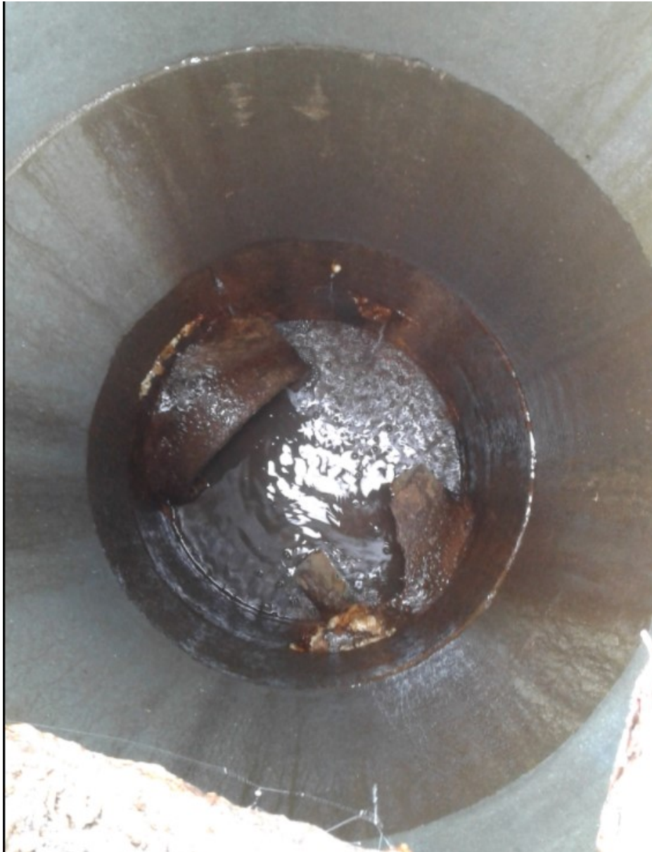
Kuva 1. Betoninen jäteveden runkokaivo vuotaa hulevesiä saumoista ja putkien läpivienneistä (Rantavuo 2021)
