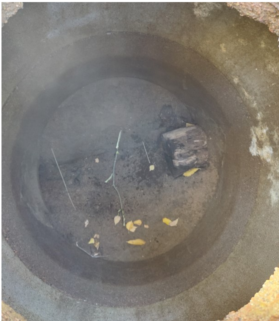
Kuva 23. Puinen tulppa viemärin lähdössä päästää savun läpi (Rantavuo 2021)
