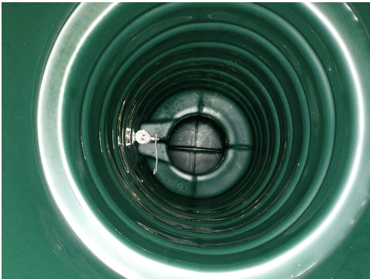
Figur 4. Insida av pumphus LPS 2000E och dess avstängningsventil. (Foto: Jimmy Englund, 2021)
