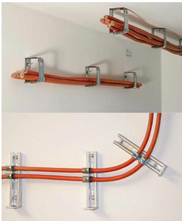
Kuva 17: Palonkestoisten kaapeleiden kiinnitykset ja tuennat. [17]
