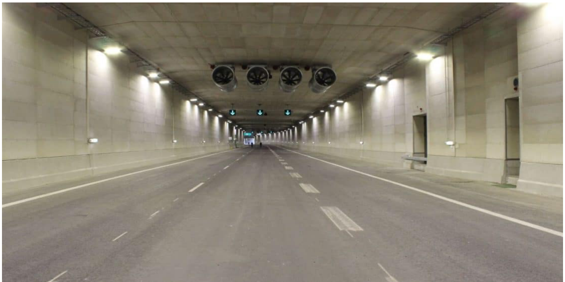
Kuva 2: Autoteiden tunneleissa käytettävät suuntapaine puhaltimet. [7]
