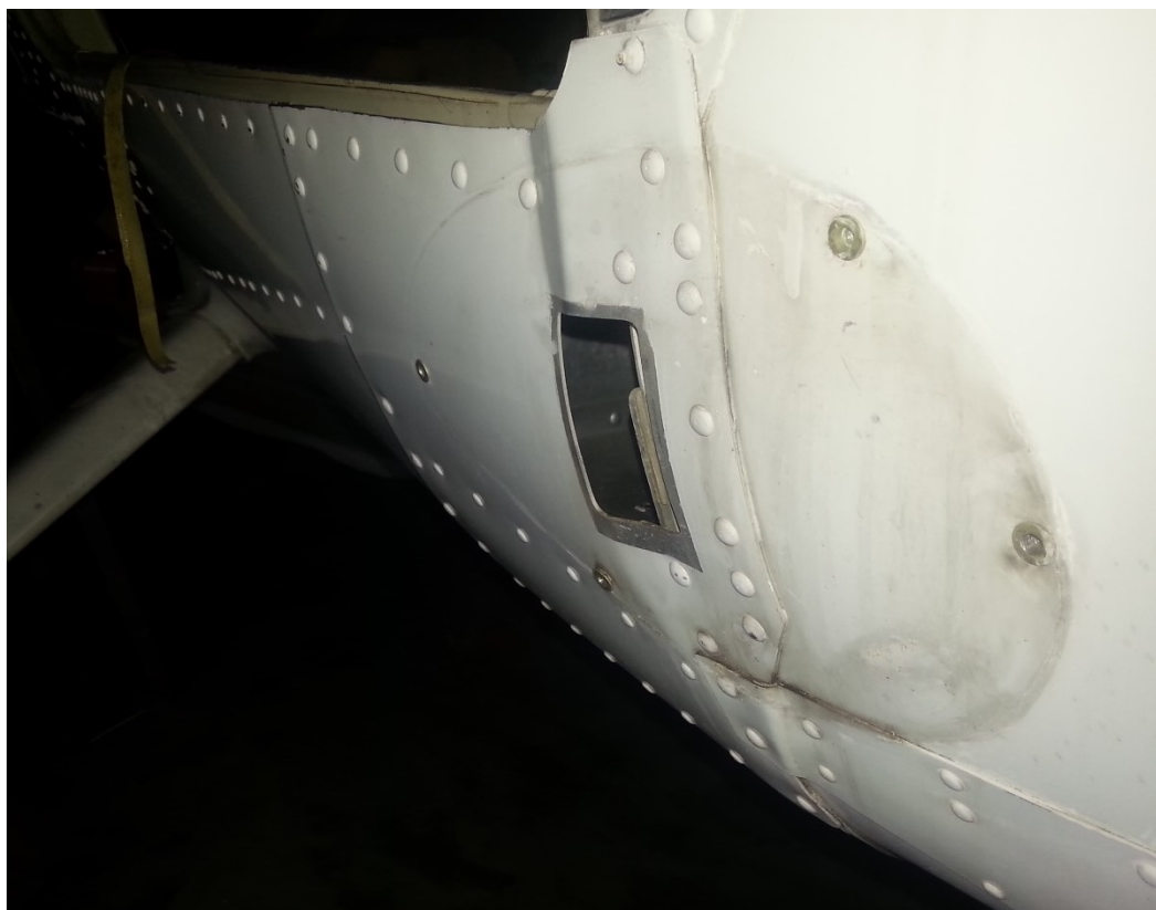
KUVA 19. Korvakkeen ympärillä olevien verhauslevyjen vaurioita (Jokelainen 2018)
